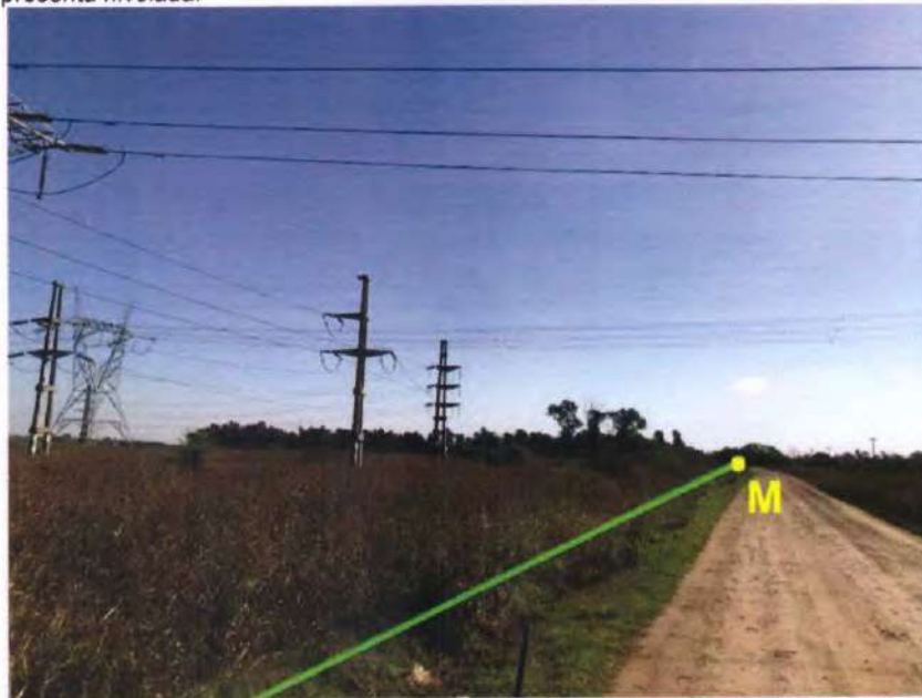
Foto 4: Tomada en el punto de la foto anterior, en sentido contrario; se advierte que en este tramo L-M, la traza subterránea atraviesa 3 ternas, en los 400 metros hasta llegar al Punto M, una LAT 132 kV, una LAT 220 kV y otra LEAT 500 kV.
