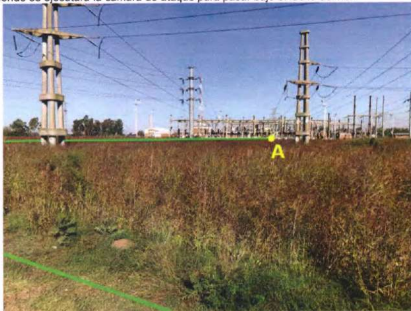
Foto 2: Tomada desde la calle Tierra del Fuego, se observa el Punto A, de inicio de la LAT 132 kV subterránea, que saliendo de la ET RAMALLO, se dispone alineada con la vía pública de la calle señalada una vez que sale del predio de la ET.
