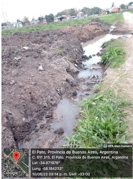
Figura N° 51 sobre 502 casi esquina 611 zanja y montículo de tierra
