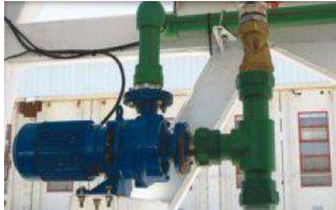
Fotografía 4. Dosificador de agua.
