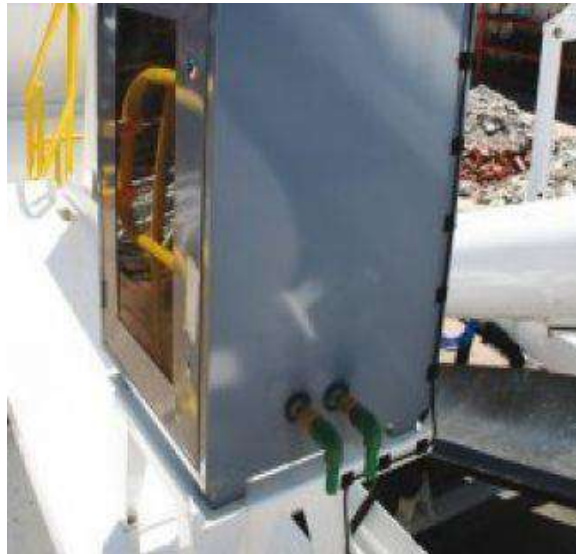
Fotografía 5. Dosificador de aditivos.
