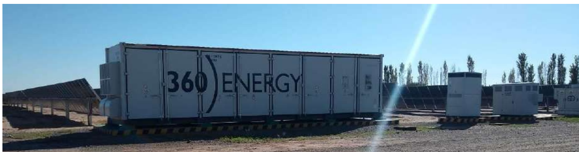
Figura 2.5 Ejemplo de BESS (PS de 360 Energy).
