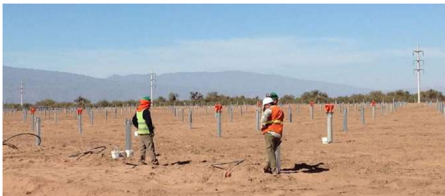
Figura 2.11 Ejemplo de montaje de soportes de estructuras en un parque solar en construcción de 360 Energy. Fuente: CCyA Ingeniería.
