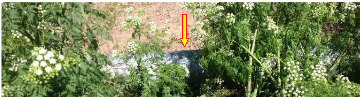
Figura 3.62 Cámaras de ABSA en las esquinas NE (izq.), NO (der.) y cañería que corre en dirección este-oeste (abajo).
