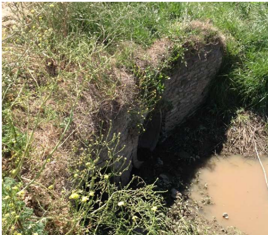
Figura 3.75 Acumulación de agua estancada del arroyo seco al cruzar el camino vecinal Entubamiento para el cruce de la calle vecinal.
