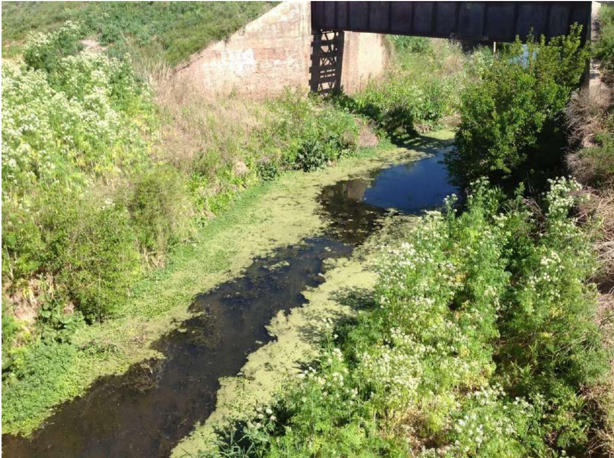
Figura 3.78 Arroyo del Pueblo, en el cruce del puente ferroviario. Hay agua estancada en el cauce, en estado de eutrofización y con emanación de olores.
