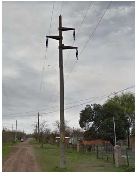
Figura 2.9 Ejemplo de poste para LMT. Fuente: 360 Energy Solar.
