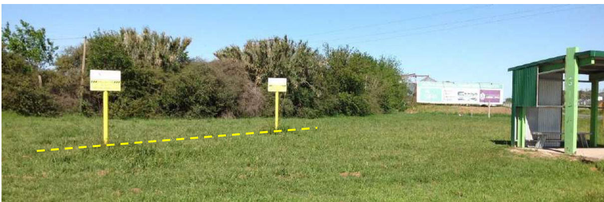
Figura 3.67 Gasoducto en esquina sudoeste del SIPA.
