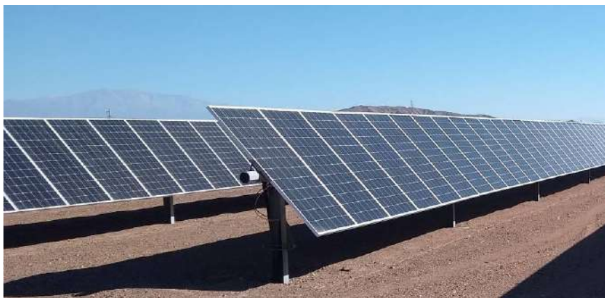
Figura 2.3 Ejemplo de seguidores de un eje (PS de 360 Energy).
