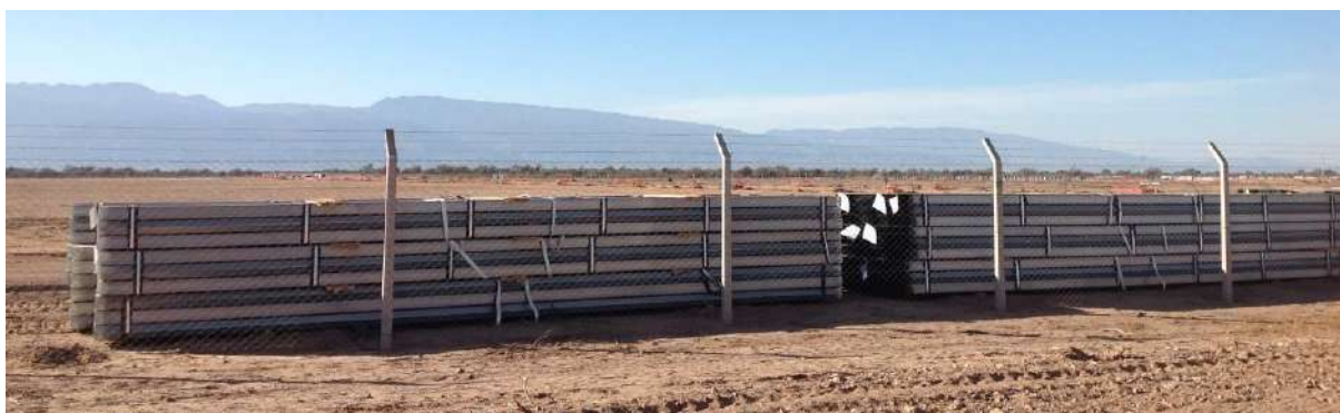
Figura 2.12 Ejemplo de acopio en el frente de obra en un parque solar en construcción de 360 Energy. Fuente: CCyA Ingeniería.
