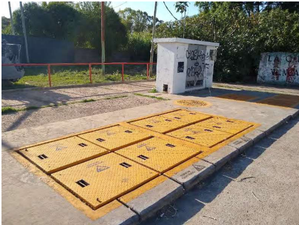
Figura 2.5 – Instalaciones de AySA existentes sobre la Av. Frías, a escasos metros del predio para la nueva EBC.
