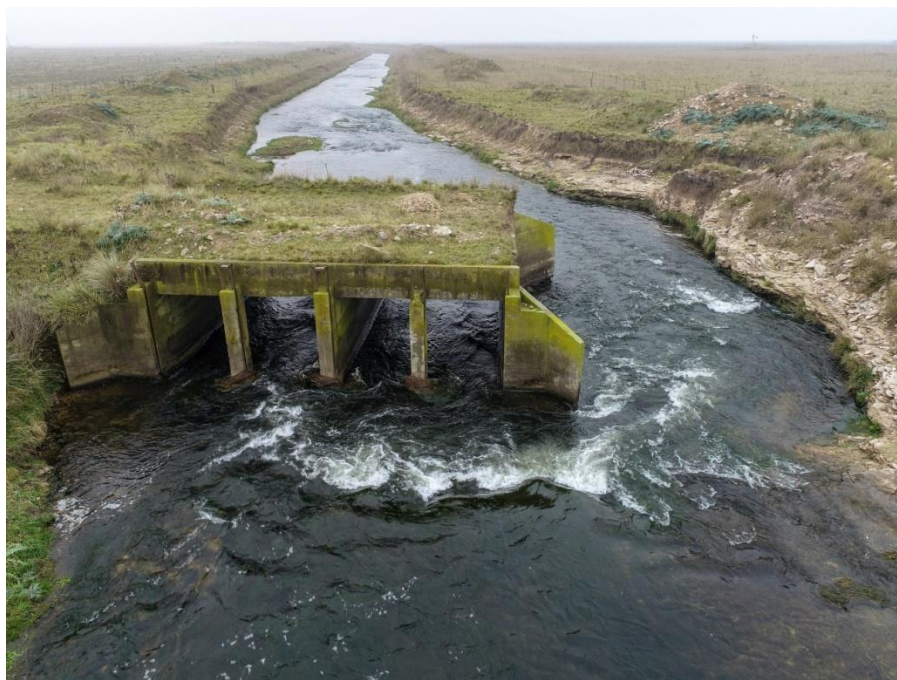
Figura 5. Vista de detalle del estado del puente existente (estructura sobre margen izquierda del A° Huáscar).Fuente: Departamento de Estudios Ambientales-Dirección Técnica- DPH.2023
