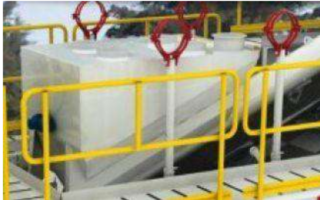
Fotografía 4. Dosificador de cemento.
