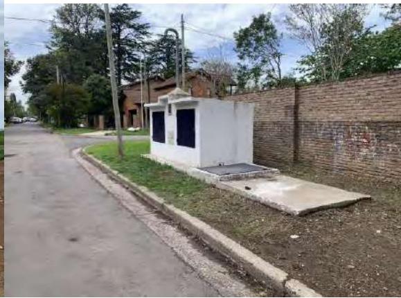
Foto 28: Pozo de agua. Tucumán y los Caldanes.
