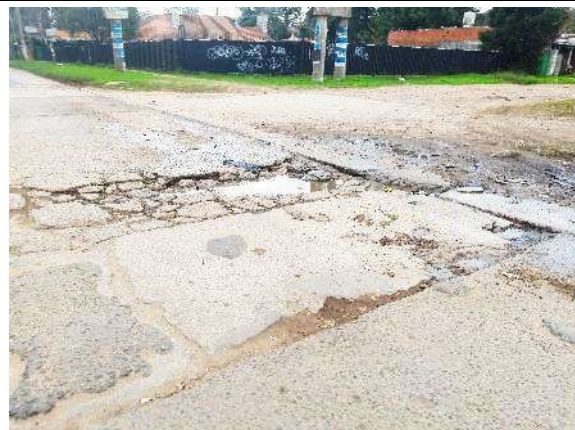
Calzada deteriorada Av. Rubén Darío.
