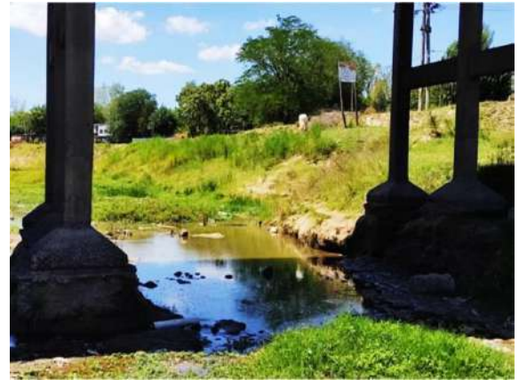
Fundaciones con evidencias de erosión hídrica. Fuente: ConinoJ.
