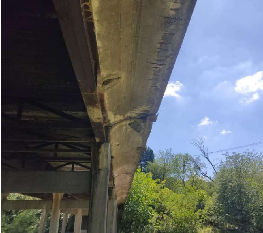
Imagen 10: Armadura expuesta bajo veredas y desagües obstruidos
