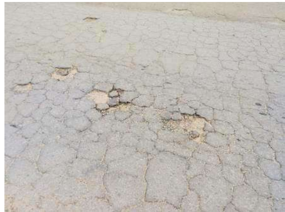
Calzada deteriorada calle Zapaleri.
