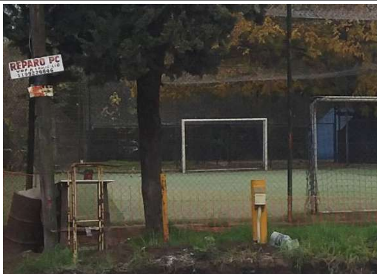
Línea de gas sobre Av. Balaguer
