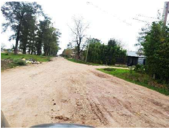
Vista general de la calzada de la calle F. de Viedma. Zona suburbana.
