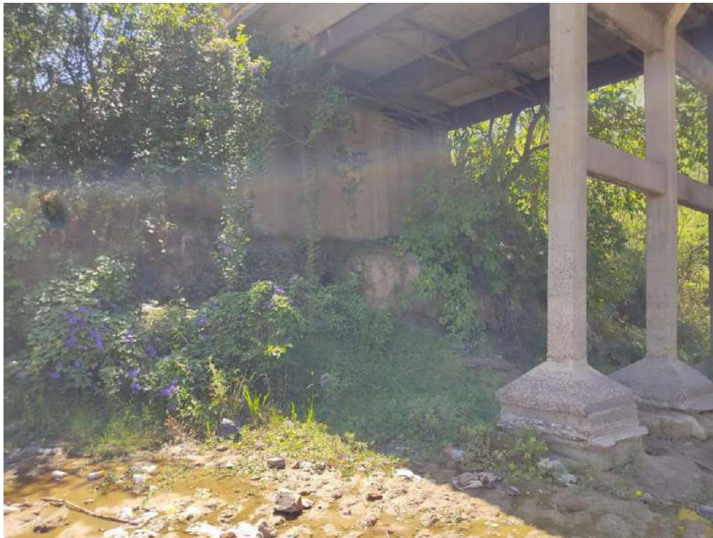
Imagen 5: Socavación de talud en margen lado Moreno
