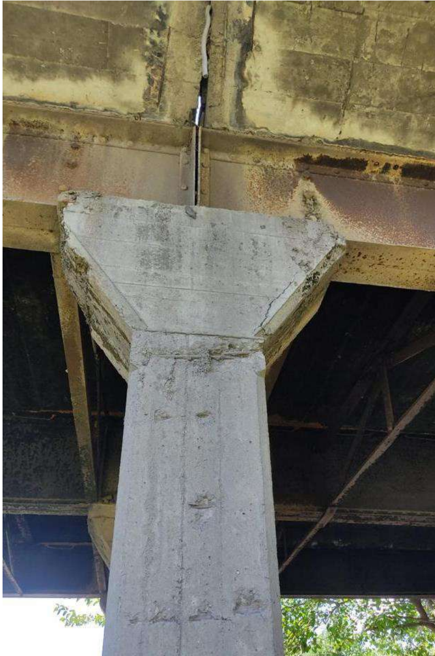
Imagen 7: Columnas en Pila – Fisuras y Armadura expuesta (También se puede apreciar la ausencia de junta adecuada en tablero)
