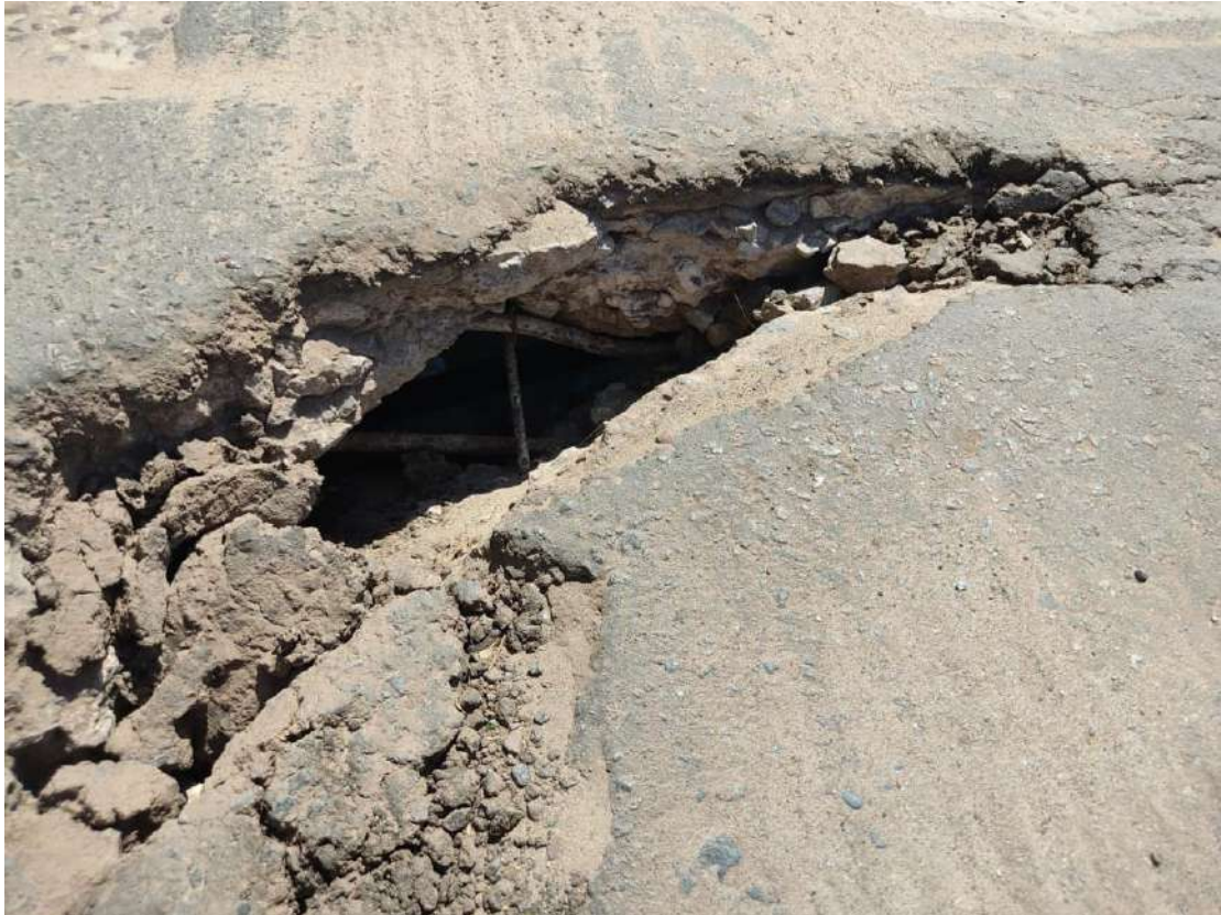
Imagen 8: Sector de losa destruido margen lado Merlo
