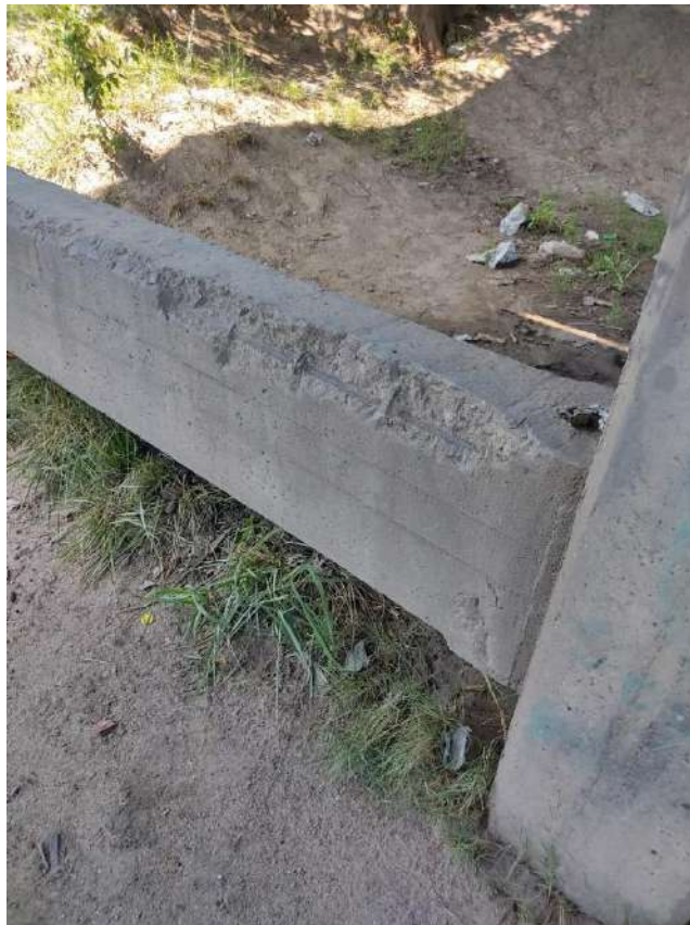
Imagen 6: Vigas de arriostre en Pila - Armadura expuesta (hierarchical)
