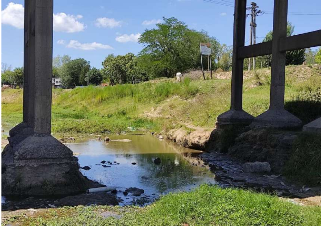
Imagen 4: Socavación de fundaciones (se observan distintas cotas de fundación)
