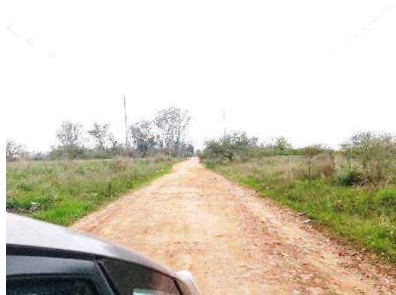
Vista general de la calzada de la calle F. de Viedma. Zona suburbana.
