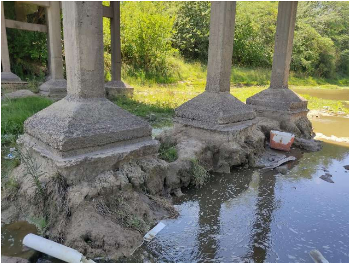
Imagen 3: Socavación de fundaciones
