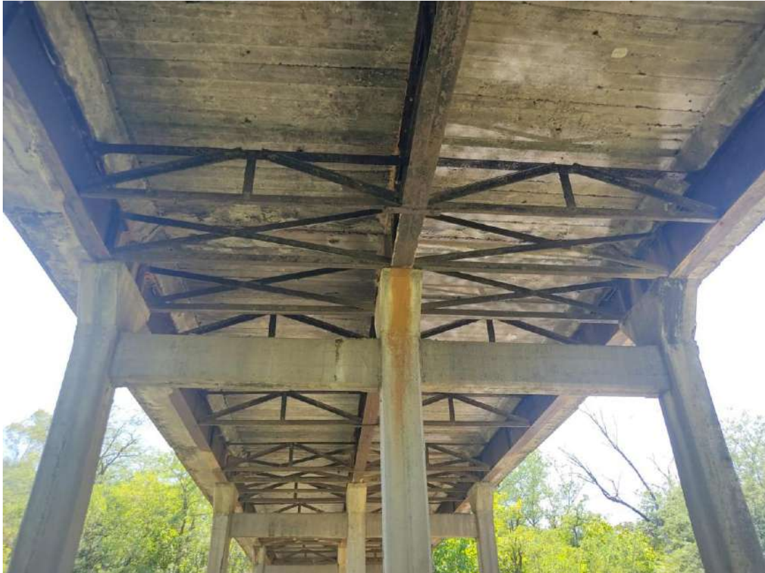
Imagen 12: Vista inferior - Vigas principales y crucetas (algunas sueltas)
