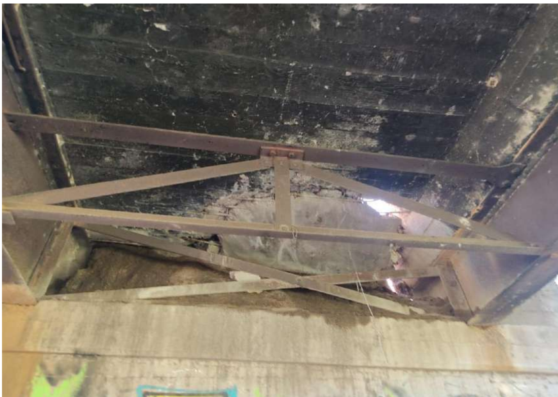
Imagen 9: Vista inferior de sector de losa destruido (en correspondencia con imagen 8)
