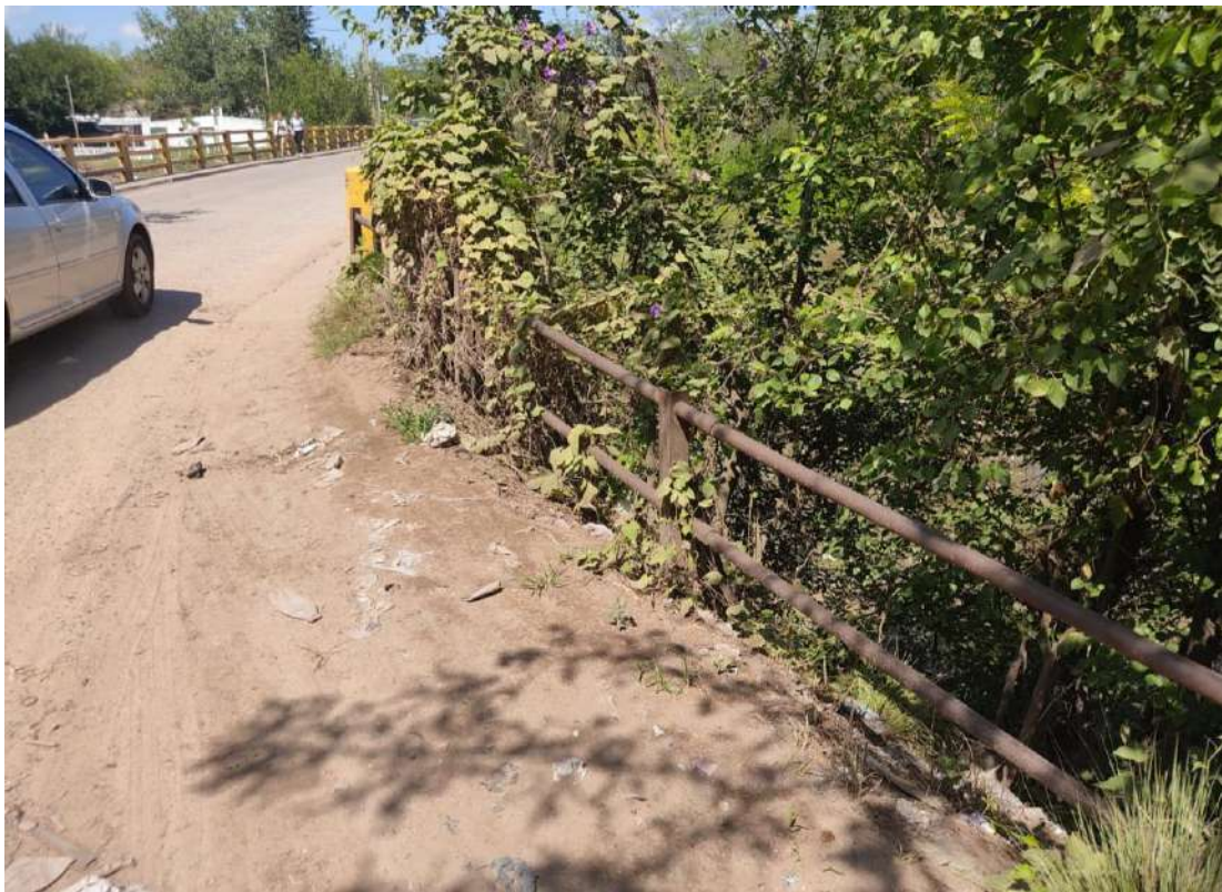
Imagen 13: Transición inexistente, defensa metálica inadecuada (margen Moreno)
