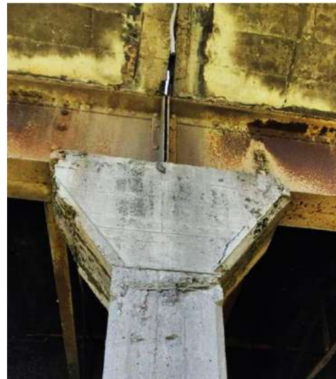
Grietas y vigas oxidadas. Fundaciones con evidencias de erosión hídrica. Fuente: ConinoJ.
