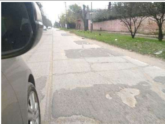
Calzada deteriorada Av. Rubén Darío.
