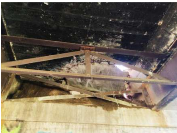
Estructura deteriorada. Fundaciones con evidencias de erosión hídrica. Fuente: ConinoJ.
