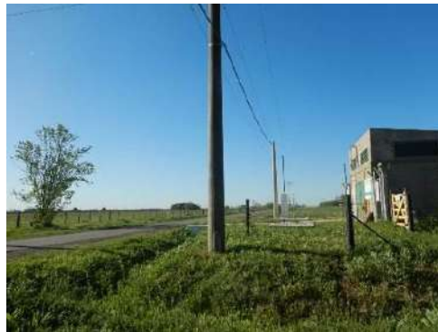
Foto 3.6-3. Vista al O, se observa el lado sur de la ERP. Se observa la presencia de tendido eléctrico S33°54'28.43"; W60°27'40.14"
