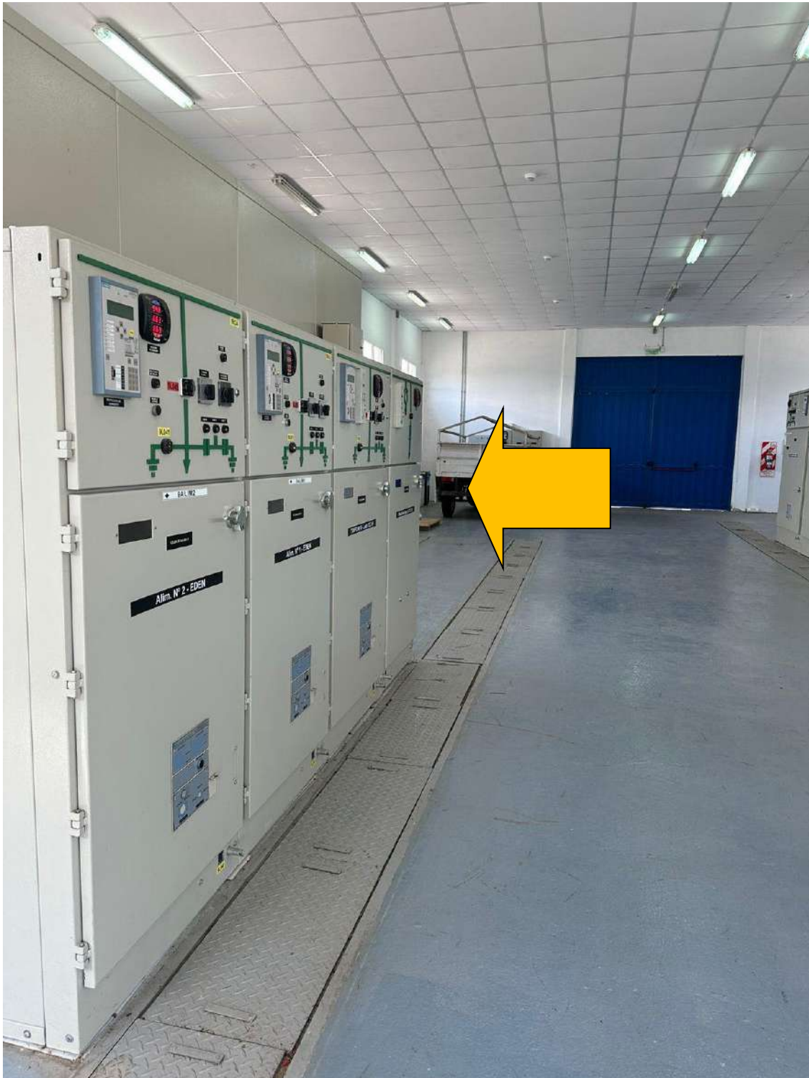
Fotografía 8 – Espacio disponible en edificio para equipamiento de control nuevo (Celdas de 13,2kV)
