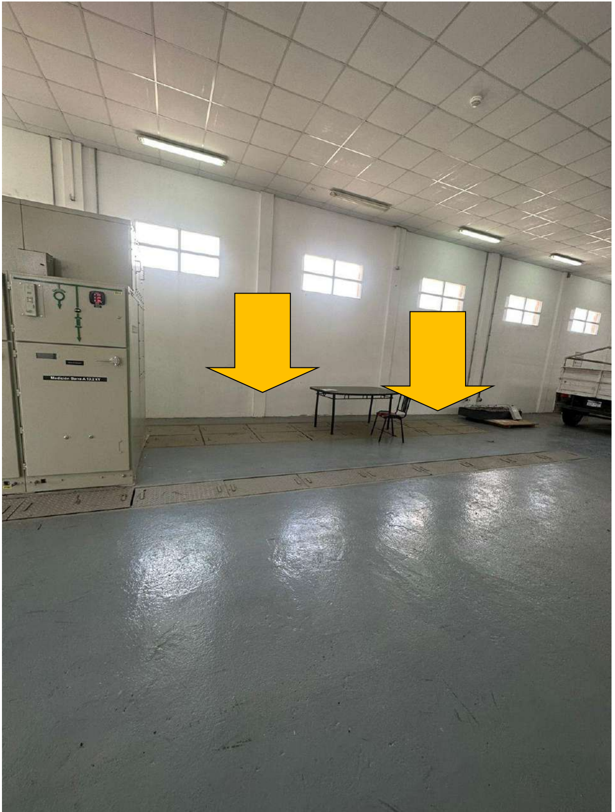
Fotografía 7 – Espacio disponible en edificio para equipamiento de control nuevo (Celdas de 13,2 kV)
