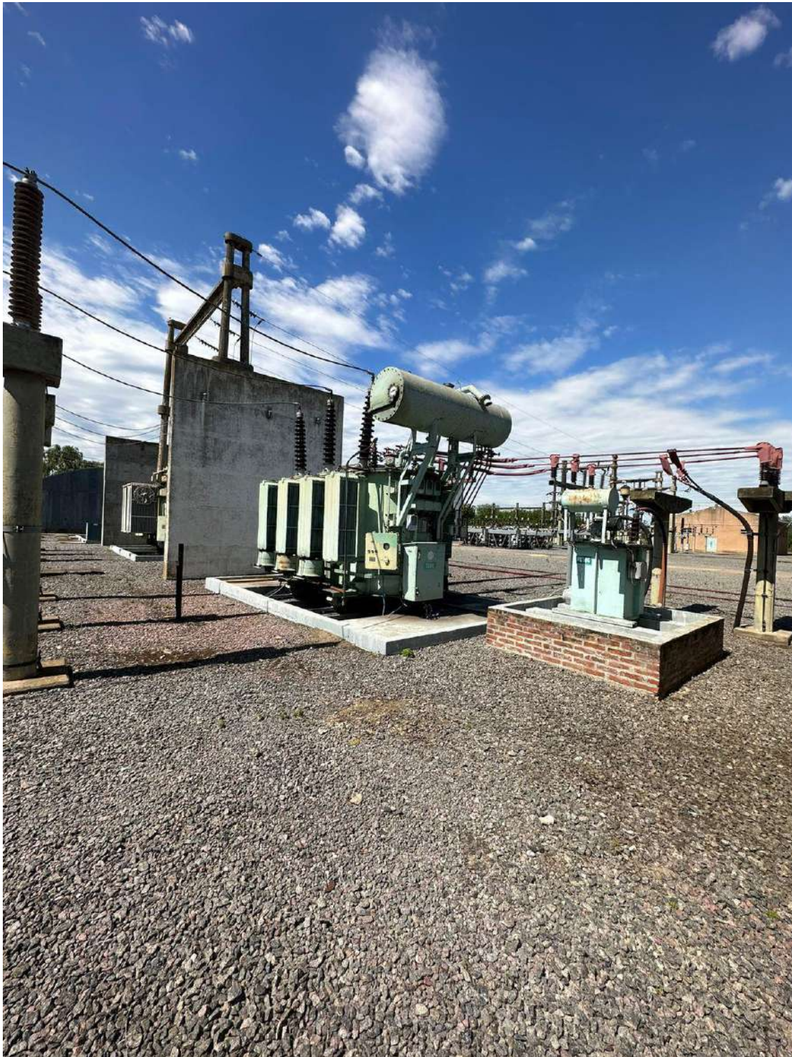
Fotografía 11 – T6BG Lado 13,2 kV
