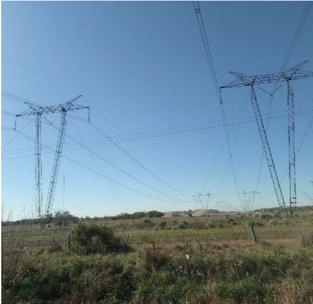
Figura 2-55. Torres de Alta Tensión próximas a R6.1.
