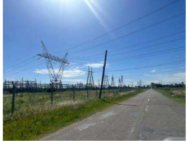
Foto 3.13. Vista de las torres y tendidos eléctricos de alta y extra alta tensión de la ET Ezeiza.
