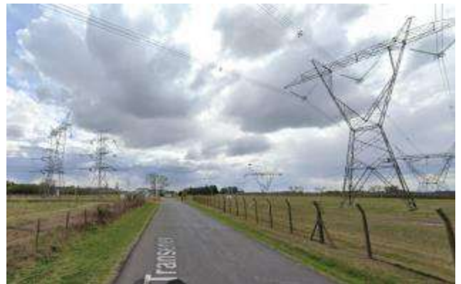
Foto 3.33. Vista de las torres de extra alta tensión que comunican la CTGEBA con la ET Ezeiza
