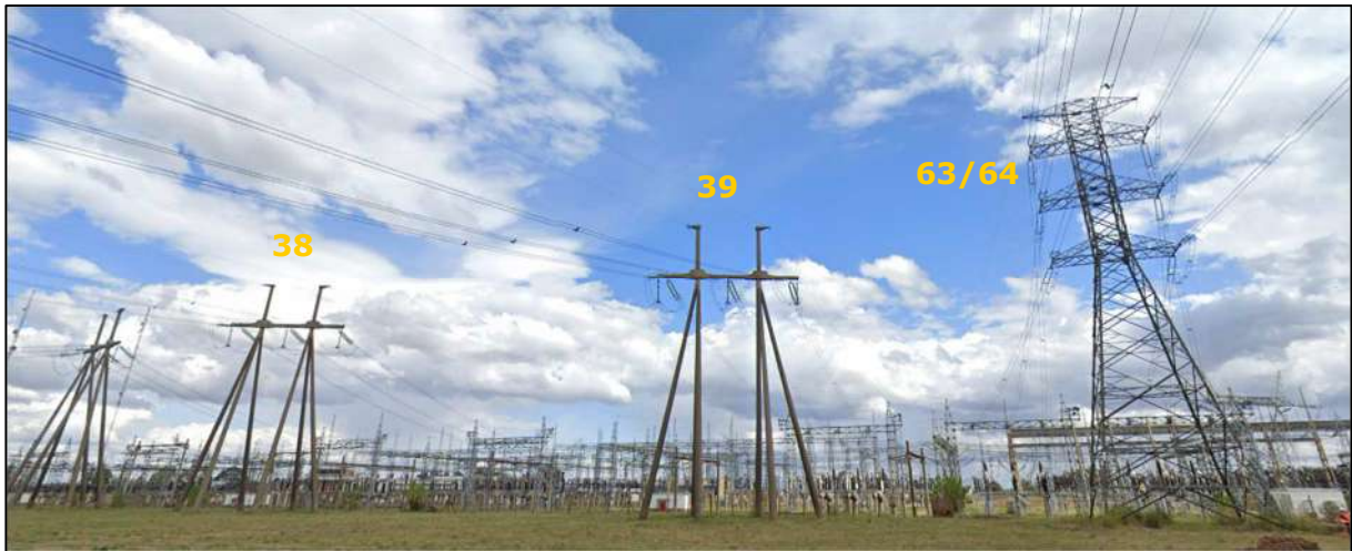
Gráfico 17. Torres terminales para LAT en 220 kV
