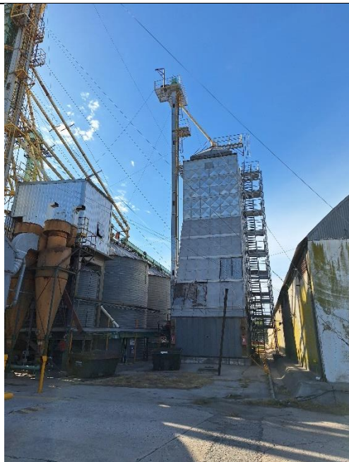
Secadora – Aspiración Carga / Descarga Camiones
