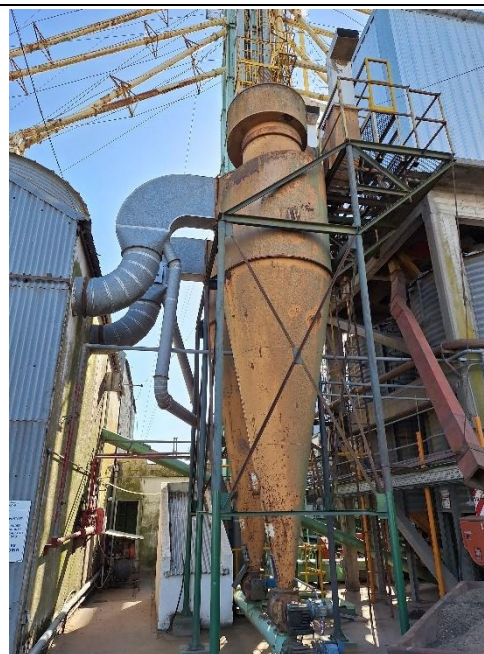
Aspiración Carga / Descarga Camiones
