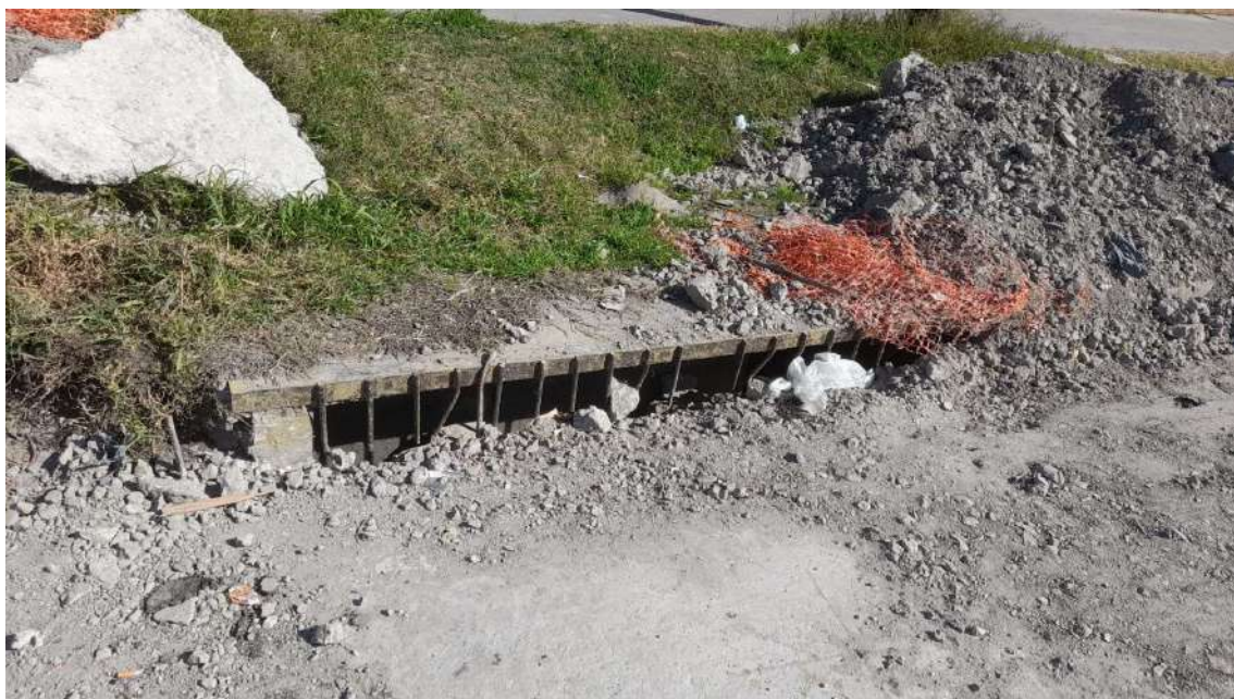
Anexo 20. Imagen correspondiente al estado de un sumidero ubicado en la intersección de las calles Deheza y Camino General Belgrano (lindero a viviendas residenciales y la empresa de sanitarios "ROCA". Fecha 5/8/23).
