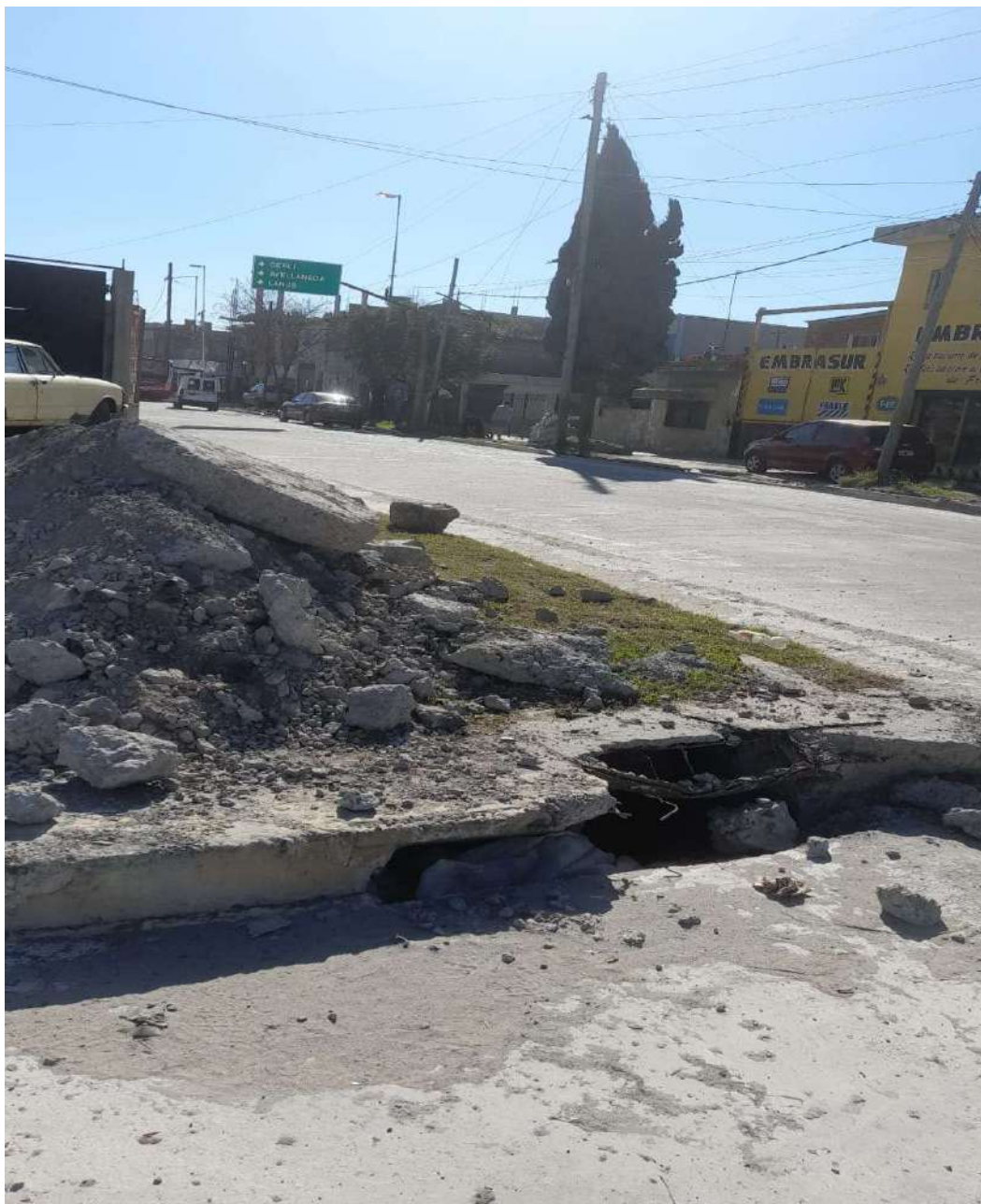
Anexo 18. Imagen correspondiente al estado de un sumidero ubicado en la intersección de las calles Deheza y Camino General Belgrano (lindero a viviendas residenciales y la empresa de sanitarios "ROCA". Fecha 5/8/23
