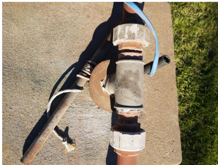
Figura: Vista del pozo de explotación presente en la Planta
