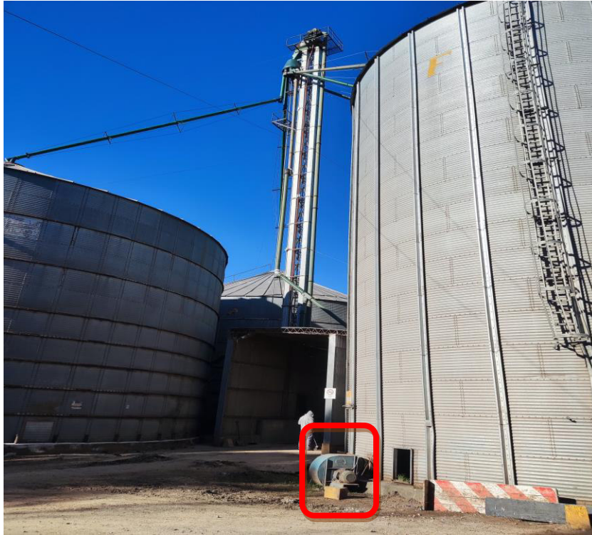
Figura: Vista de ventilador presente en uno de los silos de planta.
