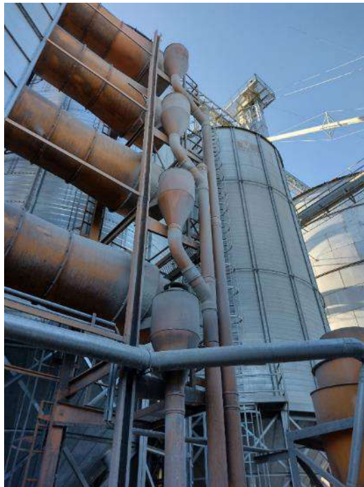
Imagen 24. Sistemas de captación de polvo (ciclones) en secadora.
