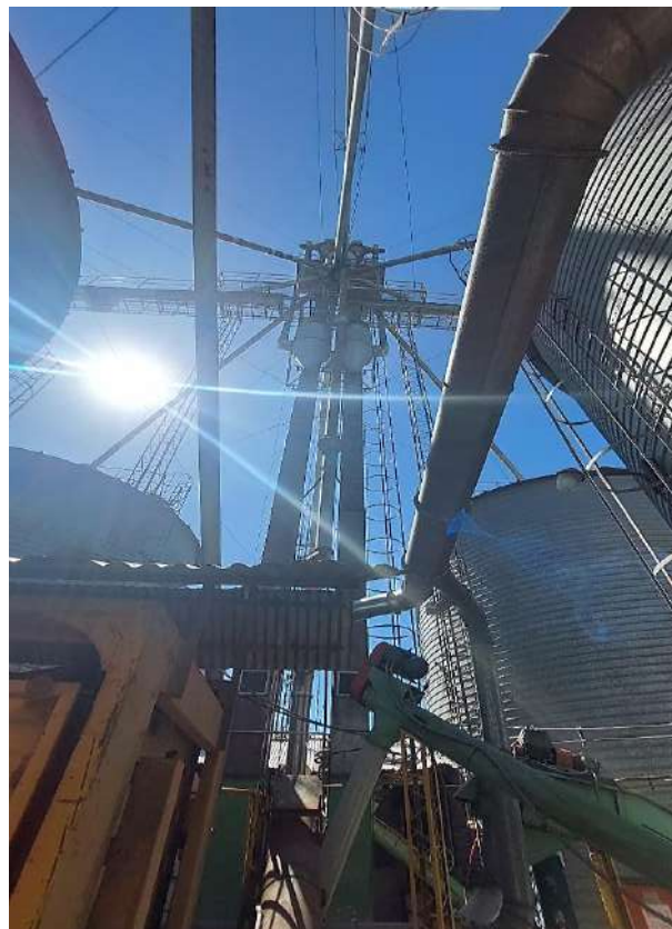
Imagen 13. Noria y sistema de captación de polvos.
