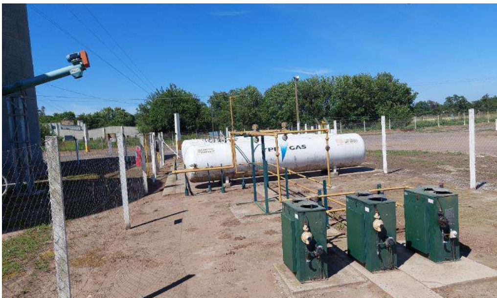
Imagen 16. Instalaciones de GLP.
