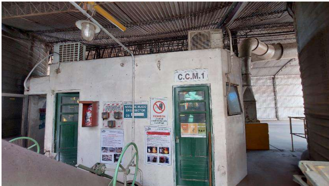
Imagen 9. Cabina de control
