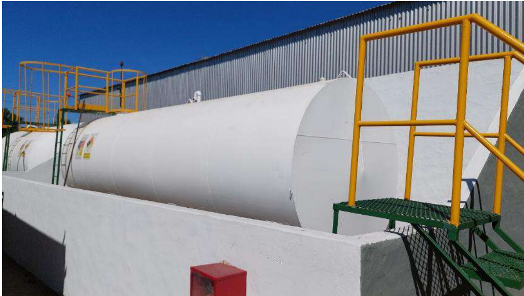
Imagen 15. Tanques de combustible.
