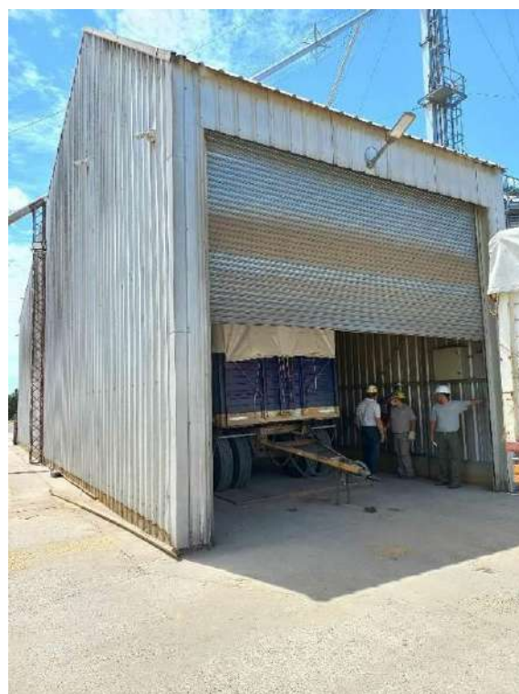
Figura: Vista del ingreso de camiones al sector de Carga/Descarga, el cual posee portones para su cierre.
