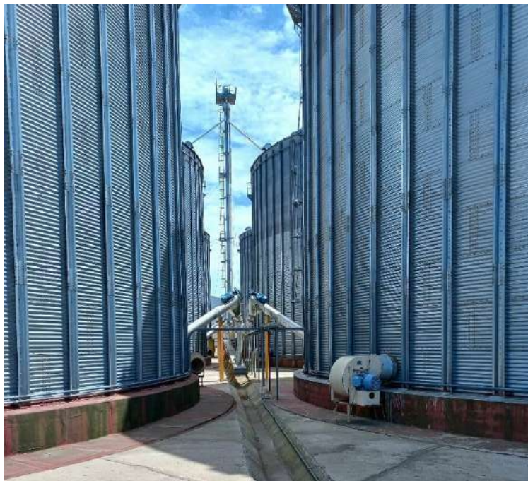
Figura: Vista de ventilador presente en uno de los silos de planta.
