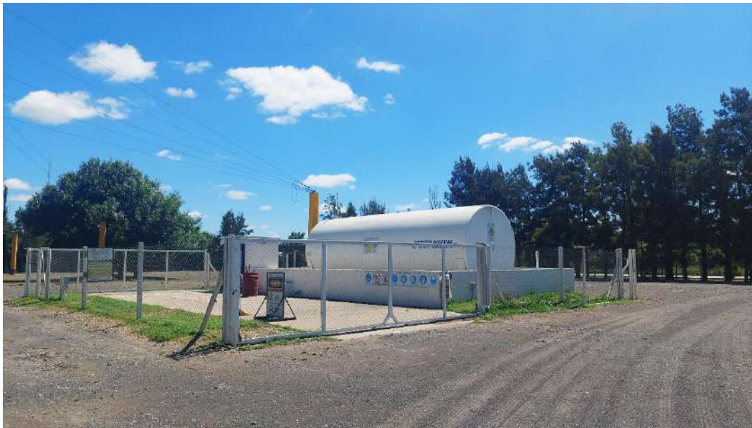
Imagen 21. Tanques de combustible.
