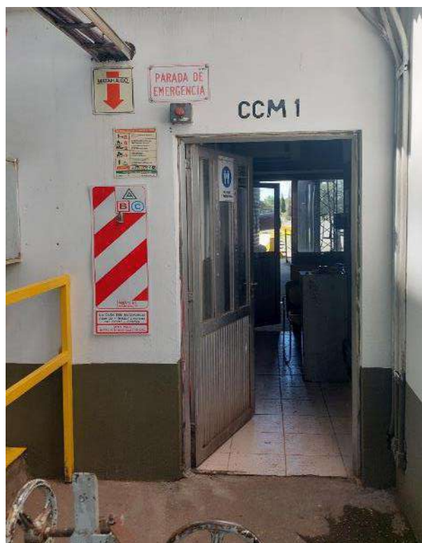
Imagen 13. Cabina de control Planta 1.
