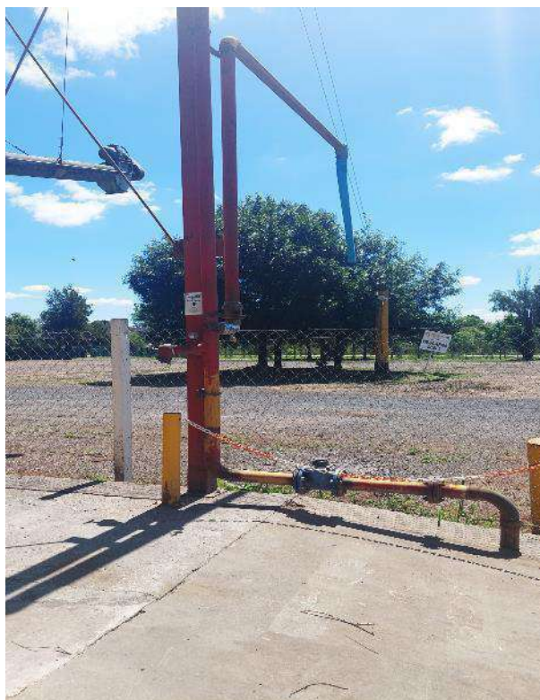
Imagen 24. Vista red de incendio.
