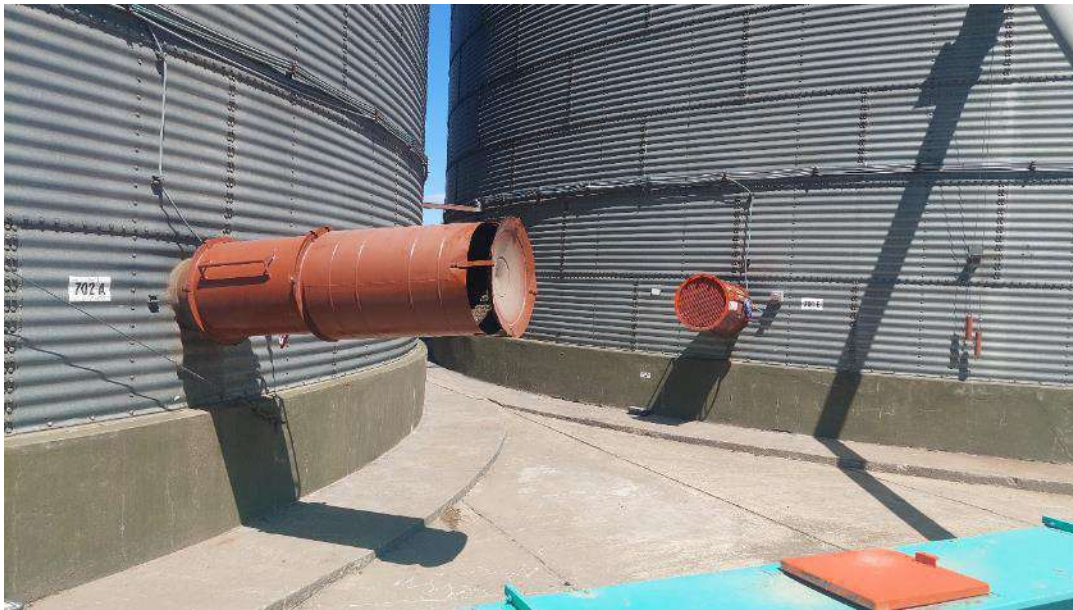
Imagen 18. Aireadores silos Planta 1.
