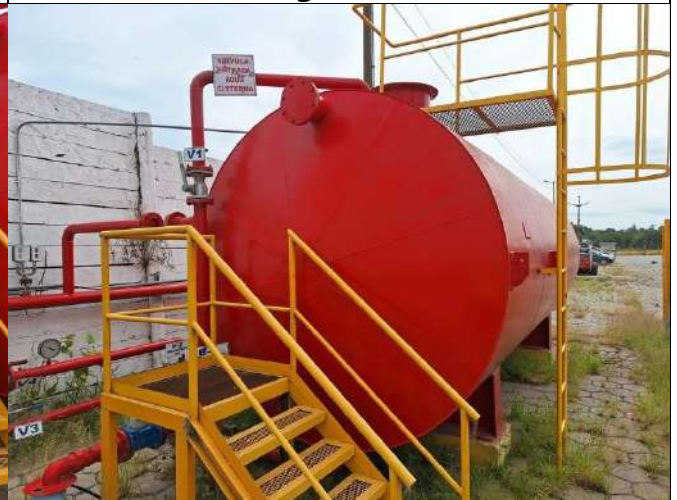
Sistema de Lucha contra Incendios
