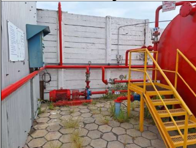
Sistema de Lucha contra Incendios
