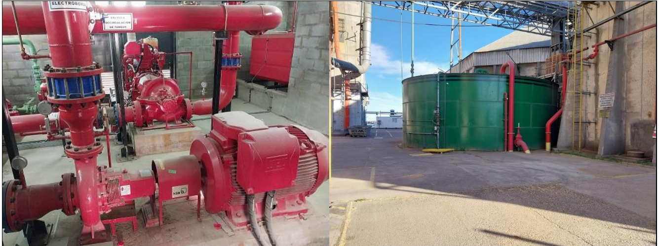
Bombas de Incendio y Tanque de Agua para Incendio
