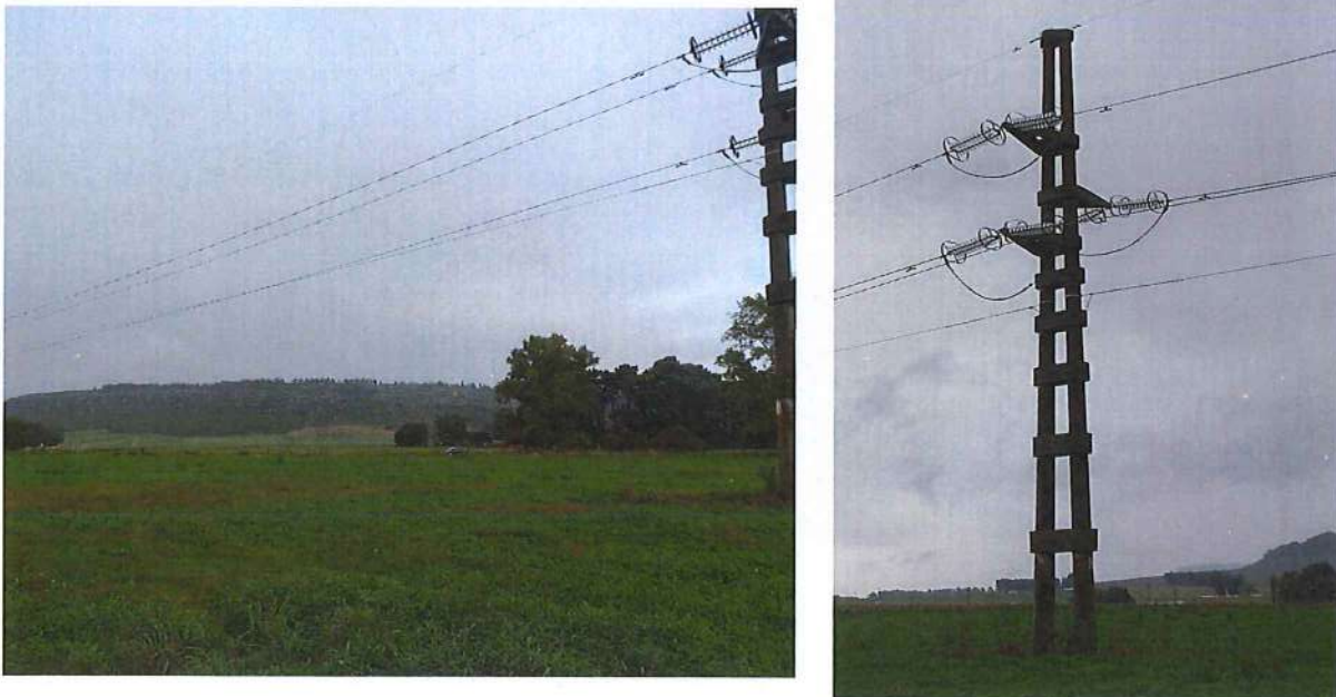
Fig. 9 - Vano de interconexión. LAT Balcarce – PIQ 154 II 132 kV y Piquete N° 222
