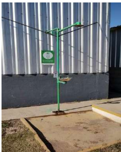
Figura: Ducha Lavaojos de Emergencia.
