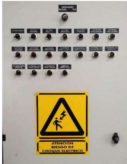
Figura: Vista de cartelería indicativa del riesgo eléctrico.
