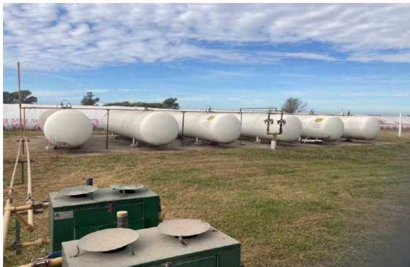
Figura: Vista de los zepelines de GLP.
