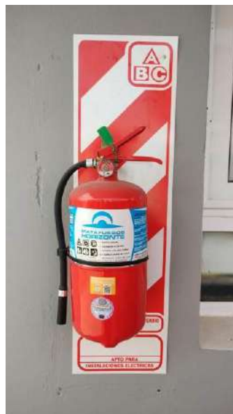
Figura: Vista de uno de los extintores de la Planta.
