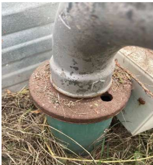
Figura: Vista de uno de los dos pozos de explotación de la Planta.
