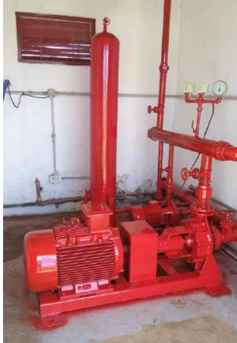
Figura: Vista interior de la Sala de Bombas de la Red Fija de Lucha contra Incendio.
