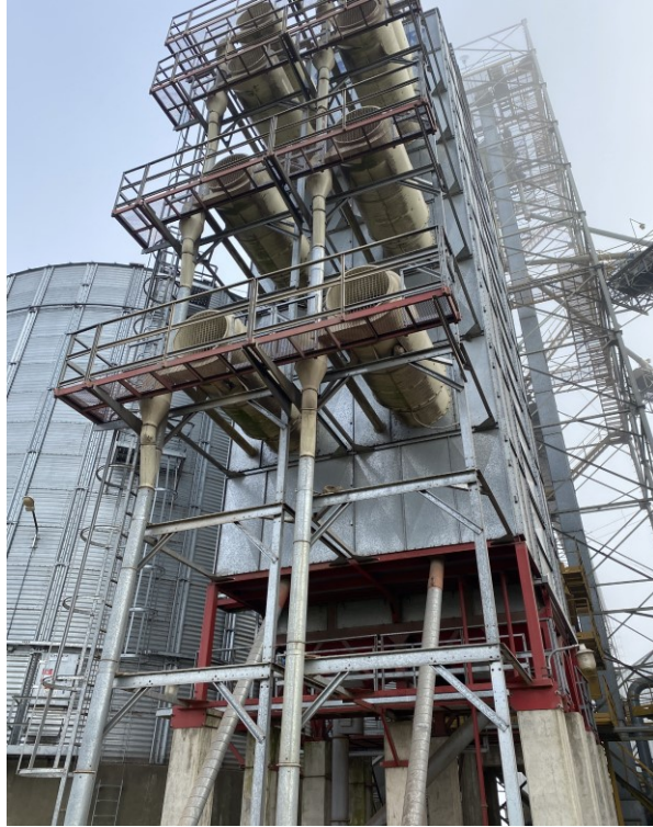
Imagen N° 6: Vista general de la secadora de granos
