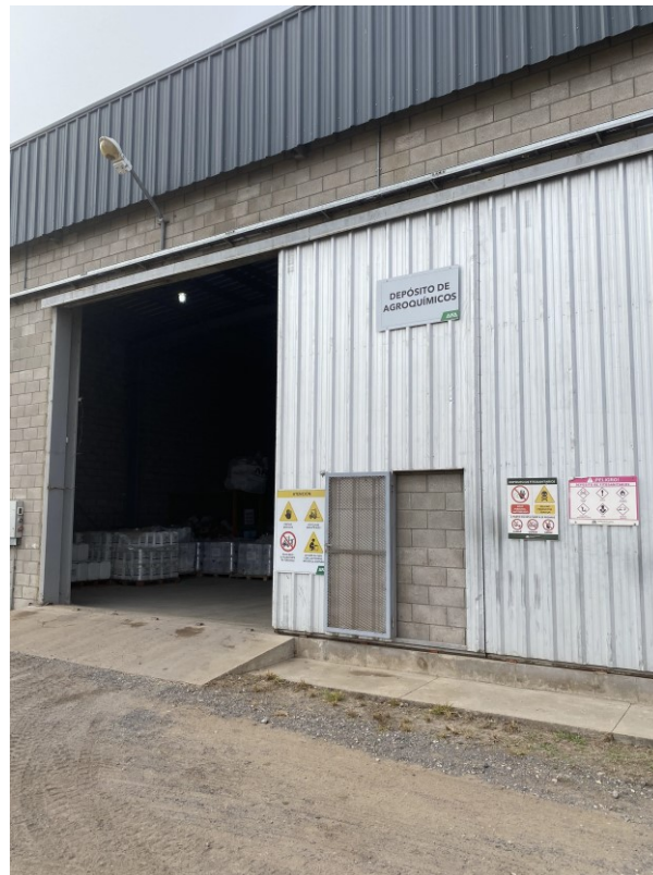
Imagen N°13: Vista del sistema de almacenamiento de agroquímicos en racks
