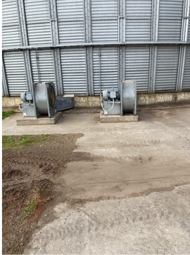
Imagen N°4: Aireadores de silos
