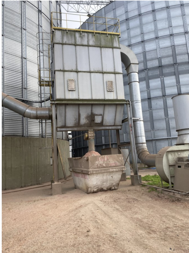
Imagen N°22: Vista del filtro de mangas de aspiraciones de planta, con colecta de polvo
