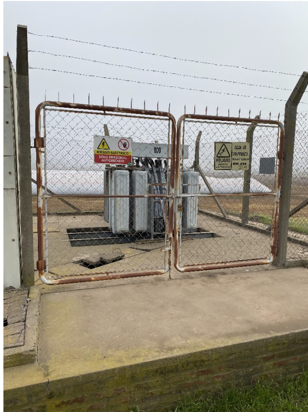
Imagen N°18: Vista de la SET de planta
