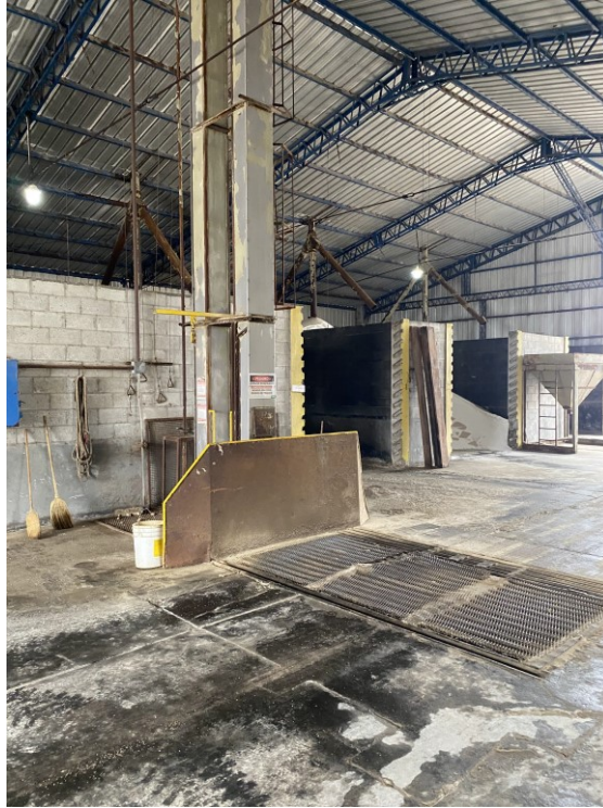
Imagen N°10: Vista del sector de reja colectora de descarga de fertilizantes, con noria lateral
