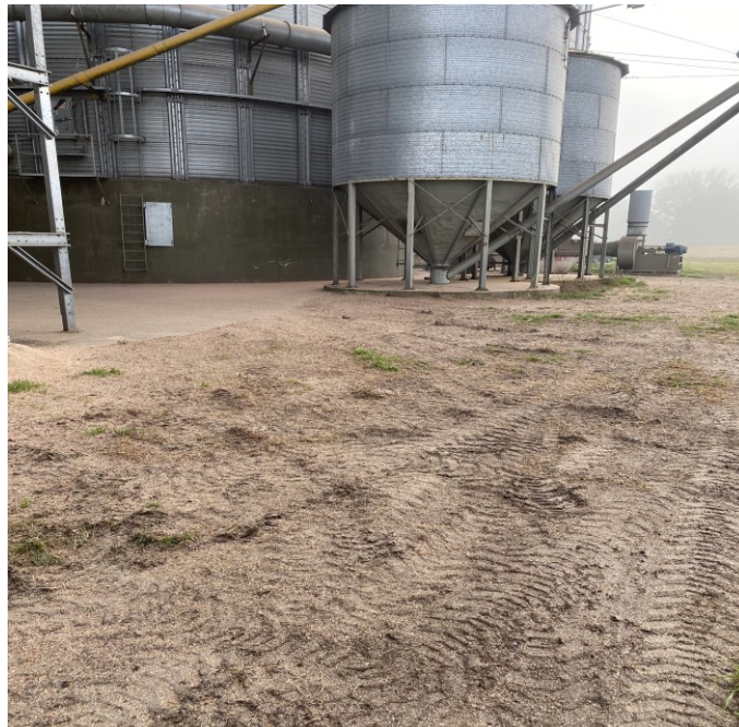
Imagen N°8: Vista de silos (tolvas) para almacenaje de limpiezas de zaranda, con ciclones superiores de venteo de corriente de aire limpio proveniente de aspiraciones de la misma.
