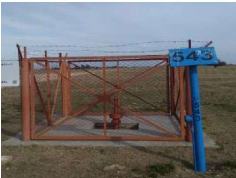
Figura 3.17 Vista Válvula VB10 AO-SA L1
