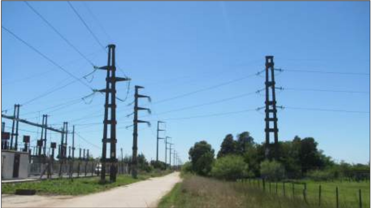
Foto 3. P1 (36.328484 S, 57.692491 W). Vista de la ET Dolores, de la traza actual de la LAT 132 kV Dolores - San Clemente por calle Sucre y de la LAT 132 kV Dolores - Las Armas, a campo traviesa.
