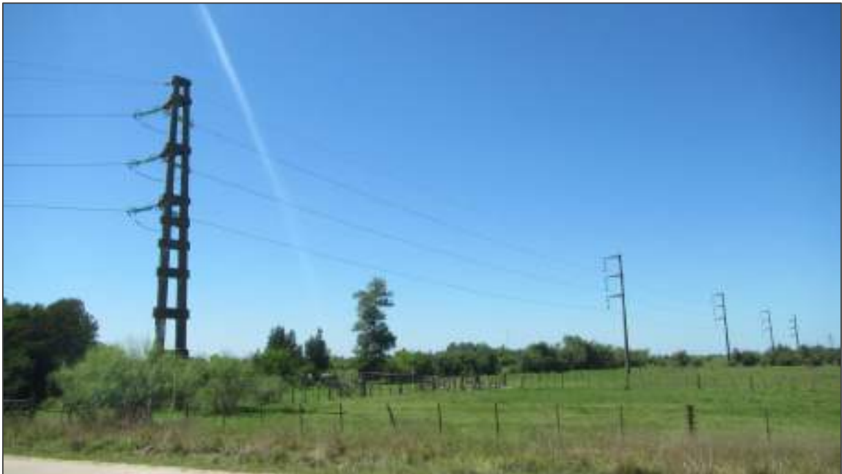
Foto 2. P1 (36.328484 S, 57.692491 W). Vista de la LAT 132 kV Dolores - Las Armas. La nueva traza de la LAT Dolores - San Clemente transcurre paralela a esta en doble terna. Los conductores de la LAT Dolores - Las Armas se incorporarán a la Doble terna y estas estructuras serán desmontadas.
