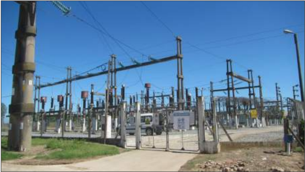
Foto 1. P1 (36.328484 S, 57.692491 W). Estación Transformadora Dolores (Transba SA).
