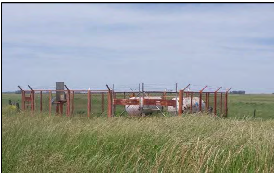
Ilustración 1-15. Progresiva 387, detalle válvula de bloqueo VB04_9
