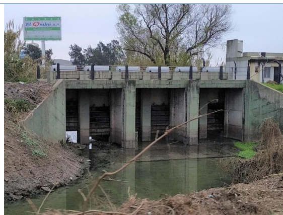
Estación de bombeo próxima a SER Bancalari
