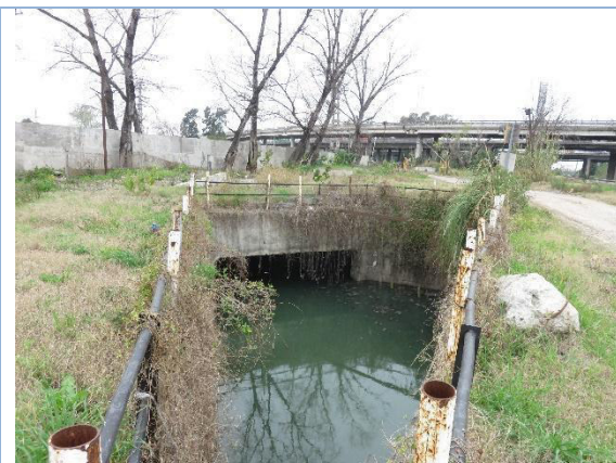
Ducto pluvial próxima a SER Bancalari
