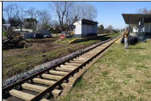
VISTA HACIA EST SCHWEITZER, SE OBSERVA TRABAJOS DE RENOVACIÓN DE VÍA ASCENDENTE
