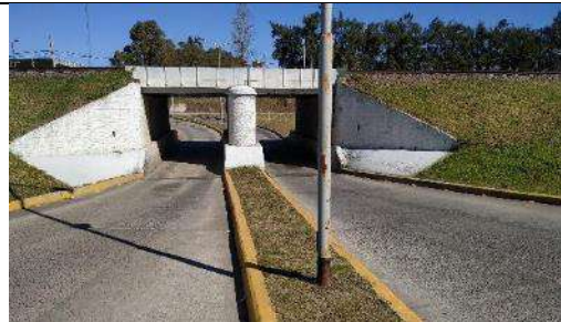
VISTA ACTUAL DE LA ALCANTARILLA HACIA LA, LA SER PACHECO SE UBICA A LA DERECHA DEL PASO
