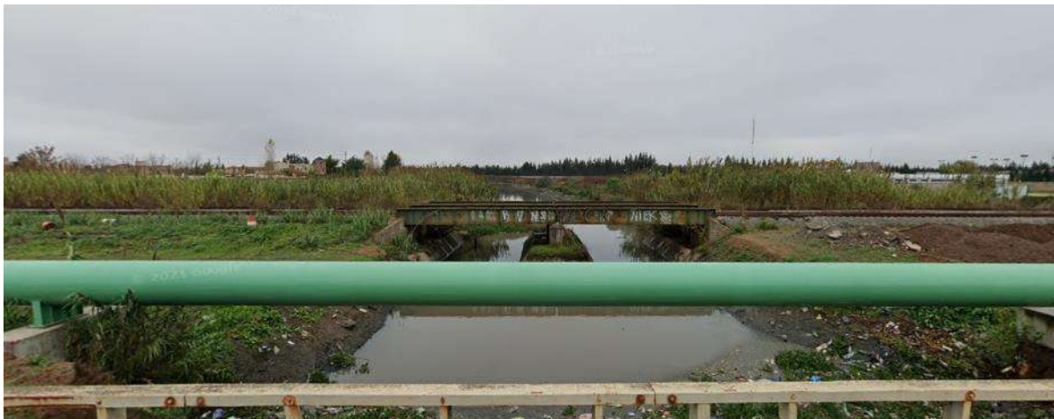
PUENTE FERROVIARIO SOBRE A° LAS TUNAS. VISTA LD DESDE EL CORREDOR BANCALARI - BENAVIDEZ
