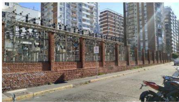
Instalaciones de la SER Martínez
