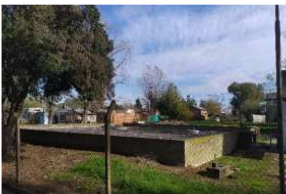
Foto 11: ABSA. Detalle de instalaciones en desuso
