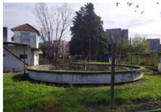
Foto 12: ABSA, detalle de instalaciones
