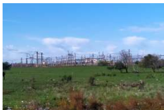
Foto 16: Vista de Subestación eléctrica
