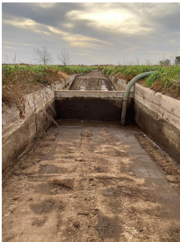
Foto 2. Canal de efluentes con decantador de sólidos
