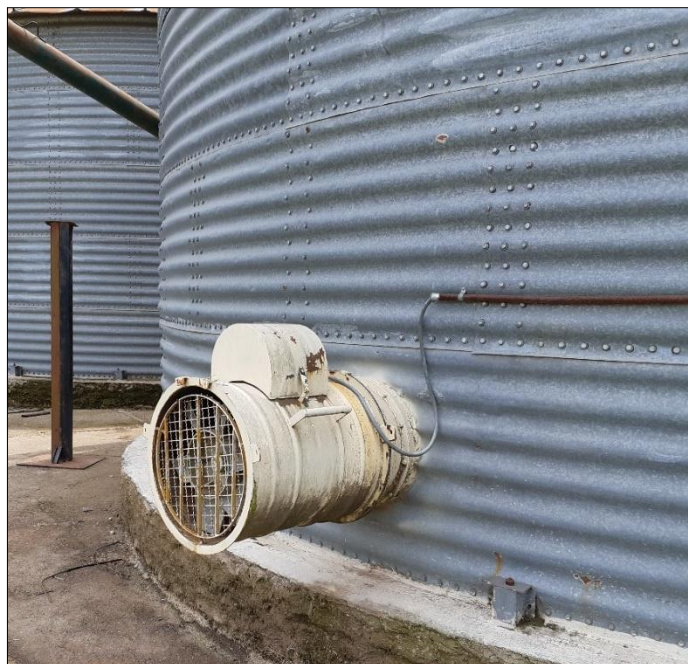
Imagen 27. Aireadores en los silos
