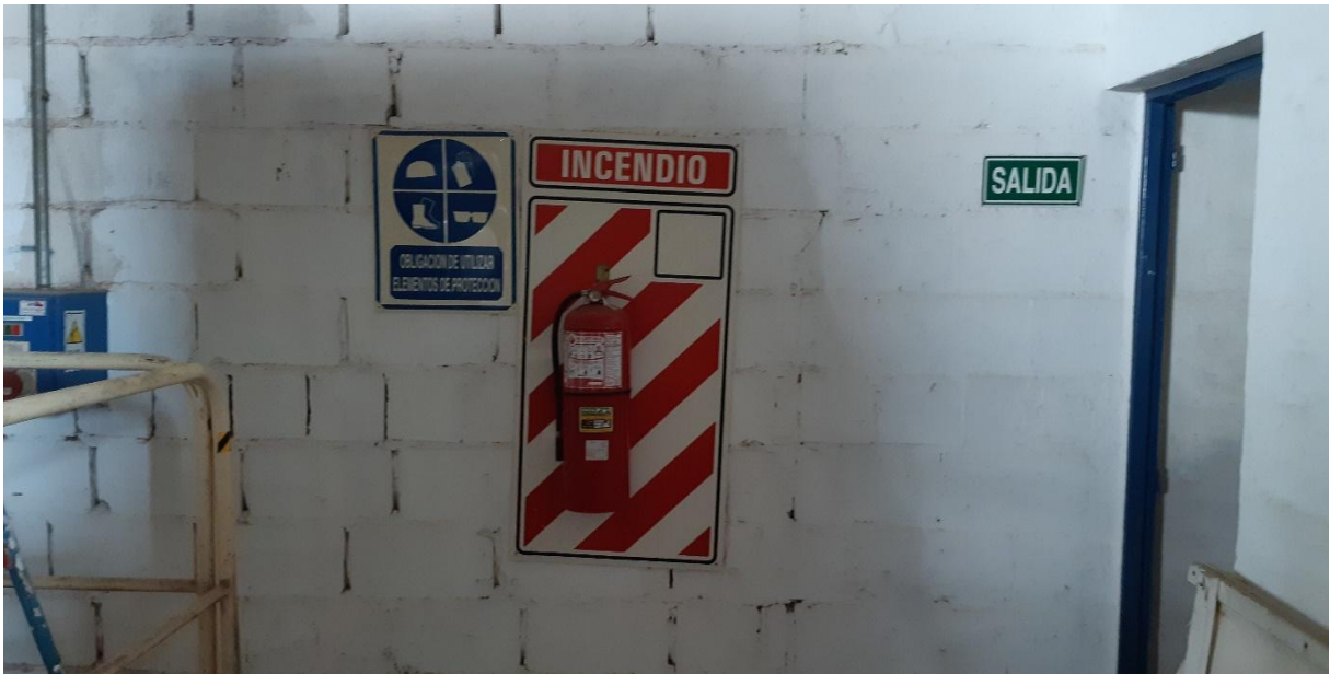
Imagen 31. Matafuego en Depósito. Carteles señalización
