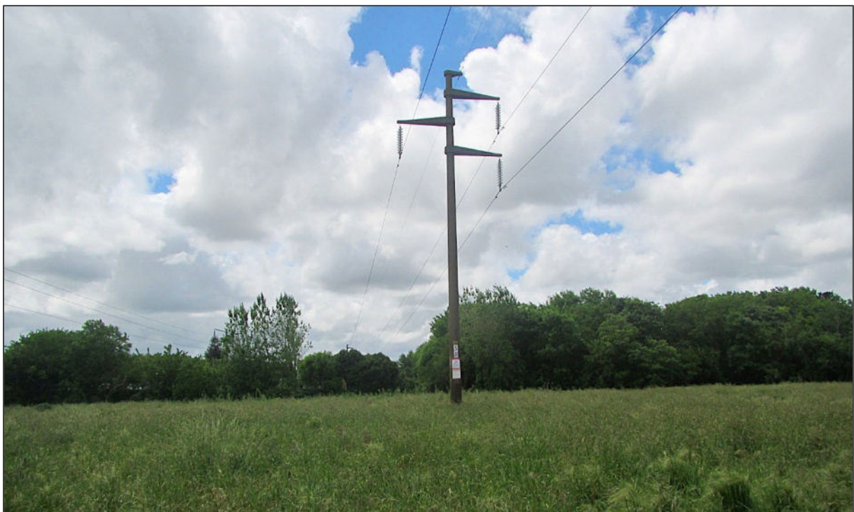
35.68350° S, 57.95220° O: P58. Traza Actual (roja). Vista de la traza hacia P57. Poste ubicado sobre terreno natural.
