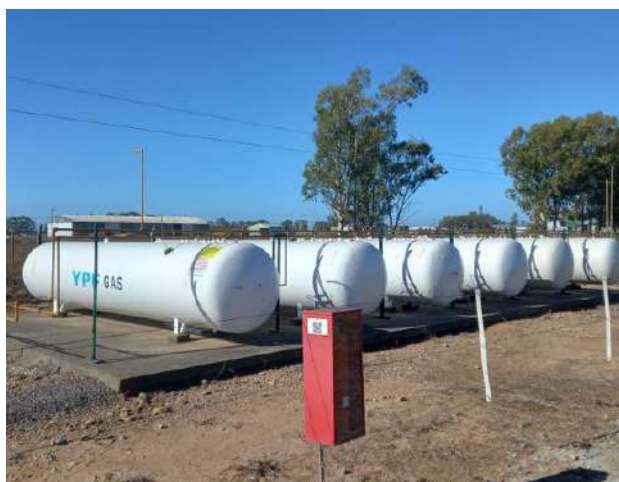
Tanques de GLP
