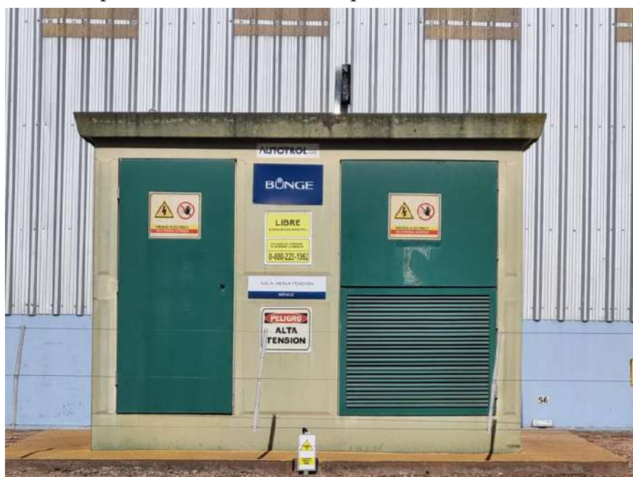
Transformador con identificación Libre de PCB
