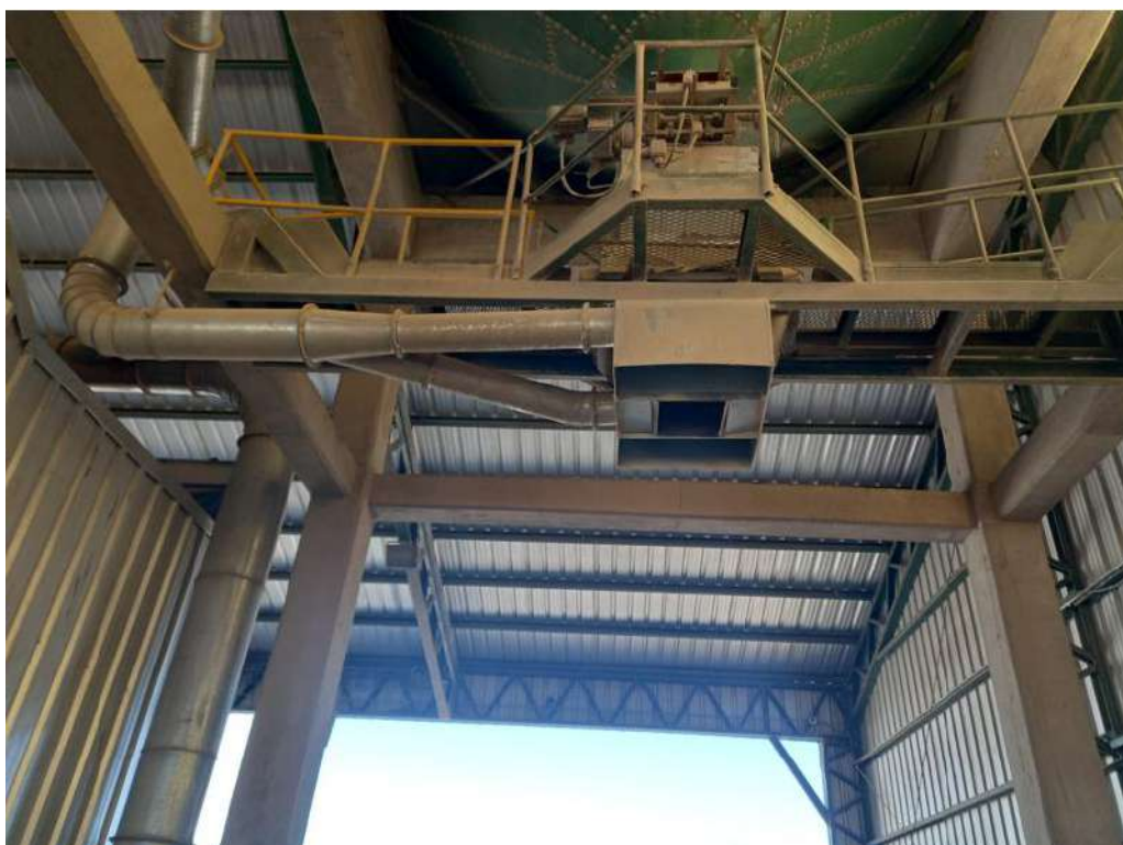
Sistema de aspiración en pulmón de carga de camiones
