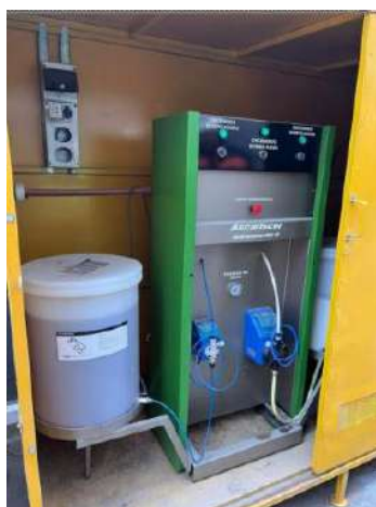
Sistema de dosificación
