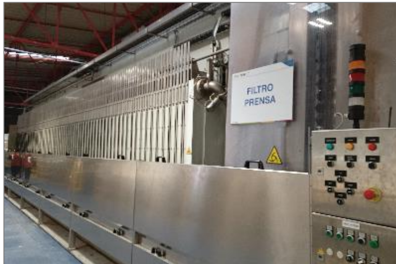
Figura: Vista del equipo de filtro prensa presente.
