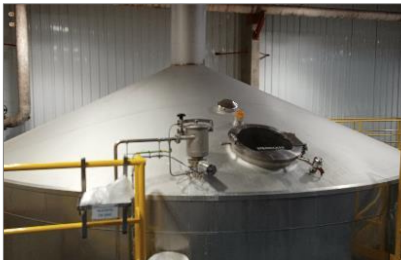
Figura: Vista del decantador (o Whirlpool).
