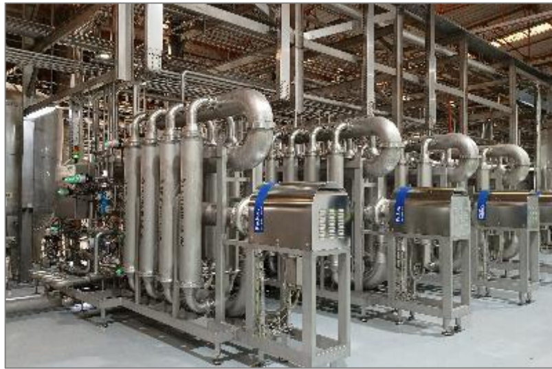
Figura: Vista de equipos de ultrafiltración presentes.
