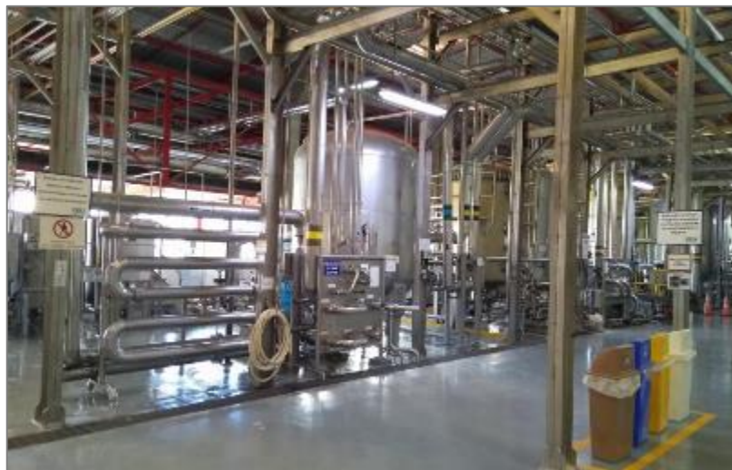
Figura: Vista de la línea de filtración mediante tierras diatomeas.
