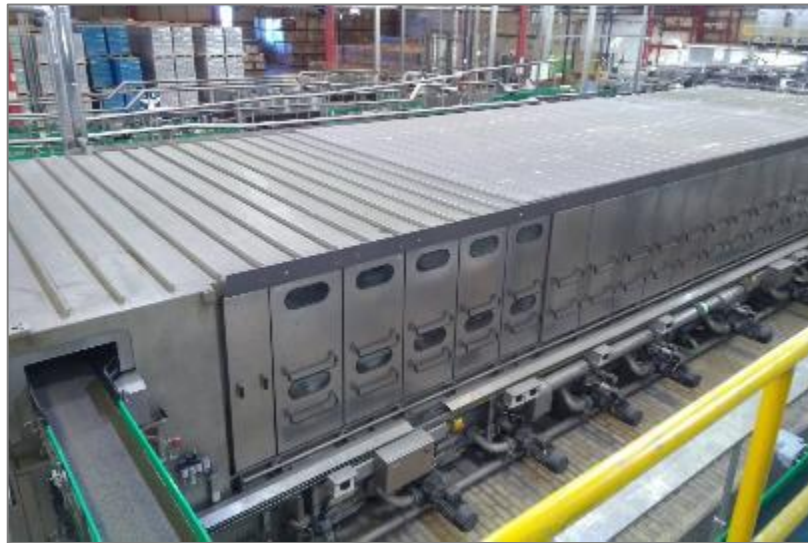
Figura: Vista de los túneles de pasteurizado.
