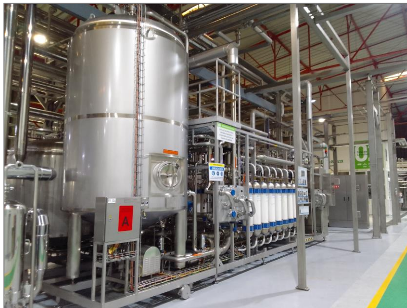
Figura: Vista de nuevos equipos de filtración presentes.
