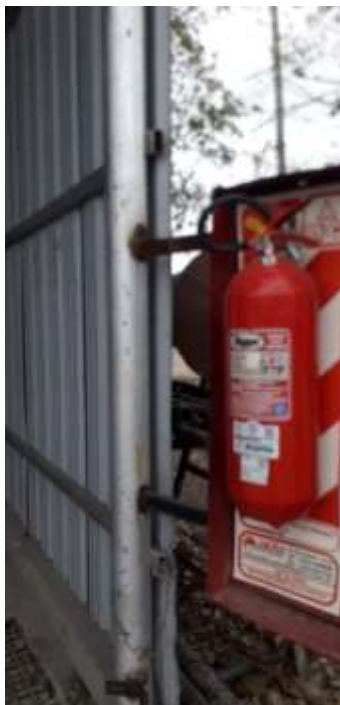
Imagen 02: Vista del portón con equipo manual de extinción de incendio
