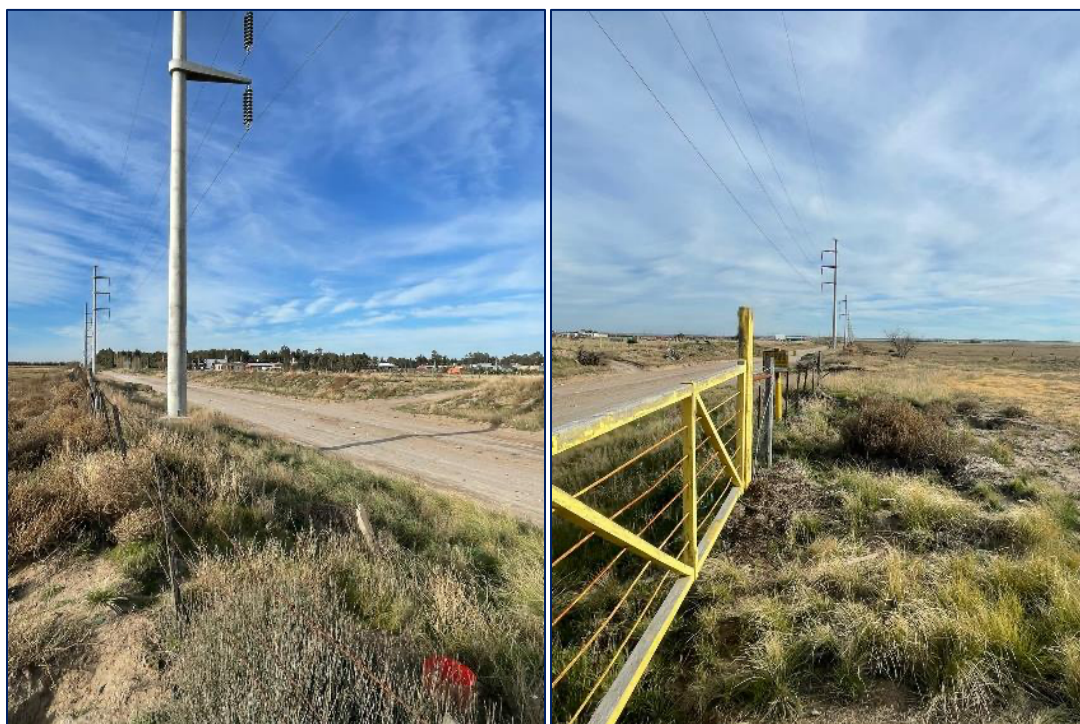
Imagen N° 1 Tendido eléctrico hacia el sur y hacia el norte, sobre la calle Ayacucho.
