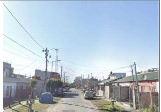
Foto 3.1-16 Pasaje San Nicolás 5300. Recorrido de línea de Media Tensión en distrito de urbanización especial - viviendas de interés social. Vista SE-NO.
