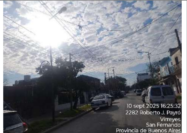
Foto 3.1-14 Calle Roberto Payró 2200. Recorrido de línea de Media Tensión en barrio residencial. Vista Sur-Norte.
