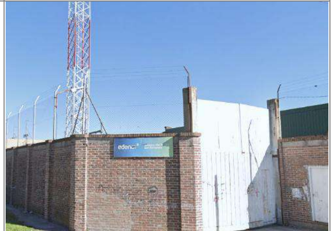
Foto 3.1-18 Planta Transformadora EDENOR.
