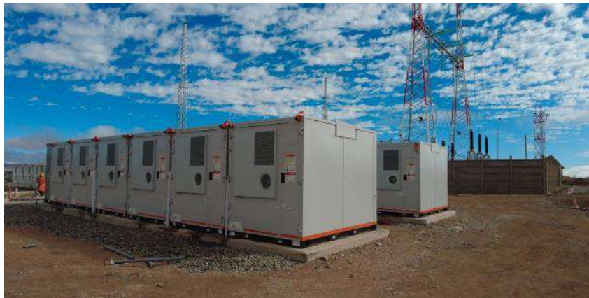
Foto 2.3-2 - Instalación de referencia del proveedor Wärtsilä.
