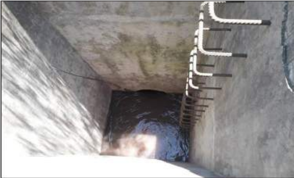
Cámara de Descarga Final. Fuente: Fotografía Propia
