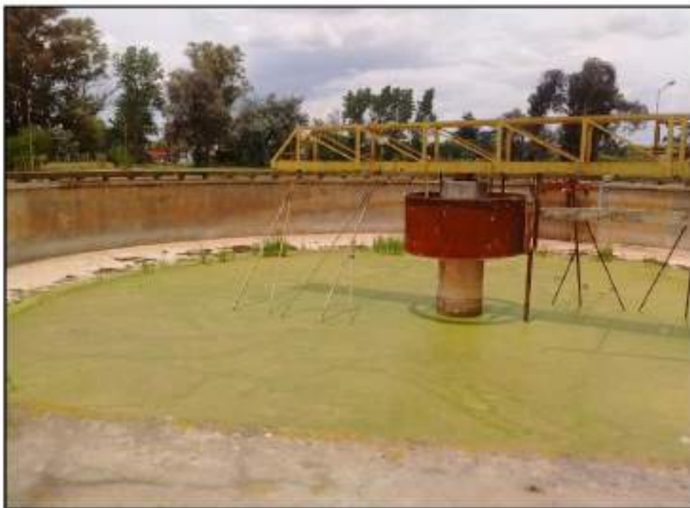
Sedimentador Secundario. Fuente: Fotografía Propia. 2017
