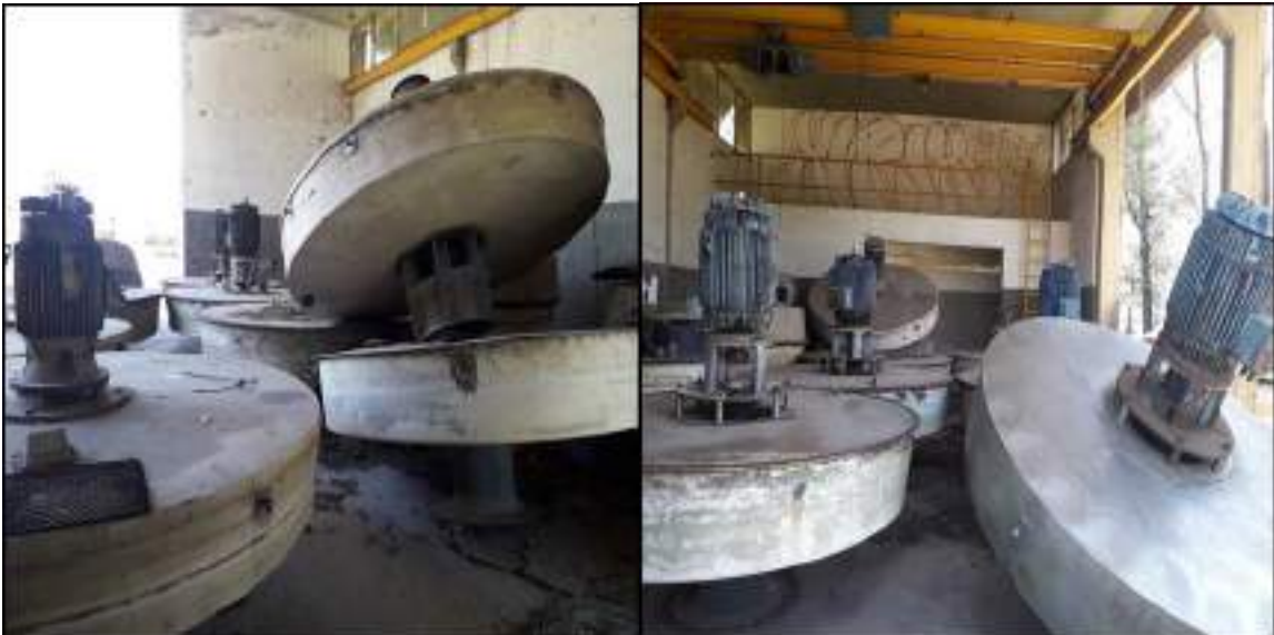
Equipos de Aireación Superficial. Fuente: Fotografía Propia.
