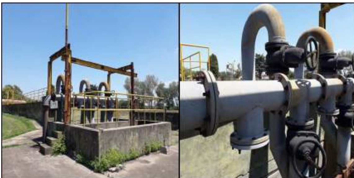
Ultimo proceso de las Piletas de Aireación. Fuente: Fotografía Propia.
