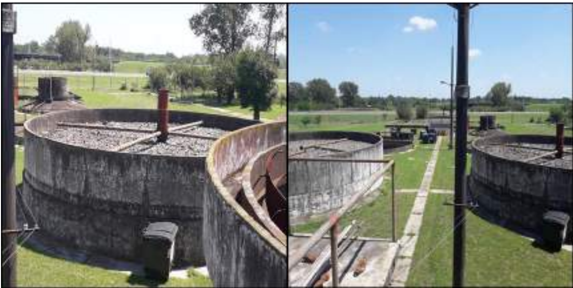
Piletas de Filtración. Fuente: Fotografía Propia
