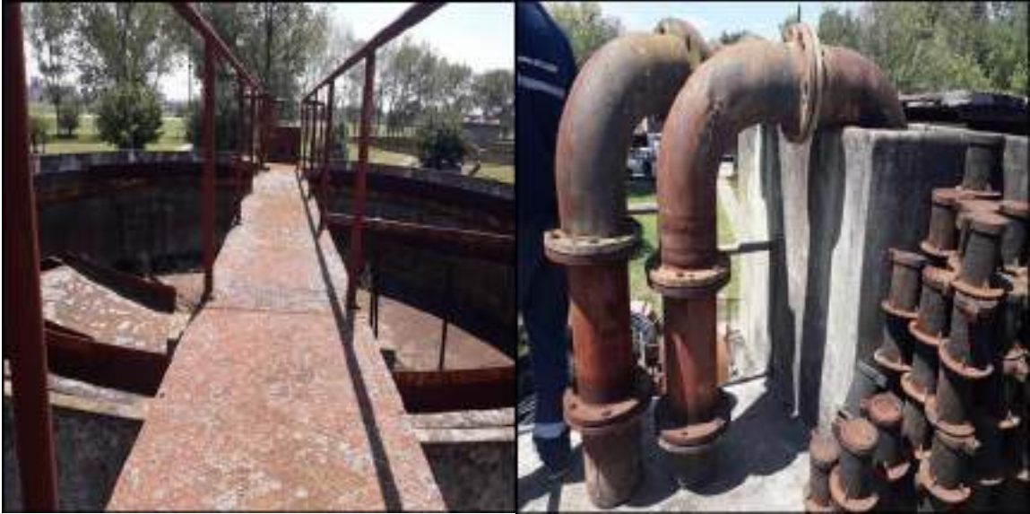
Sedimentadores. Fuente: Fotografía Propia
