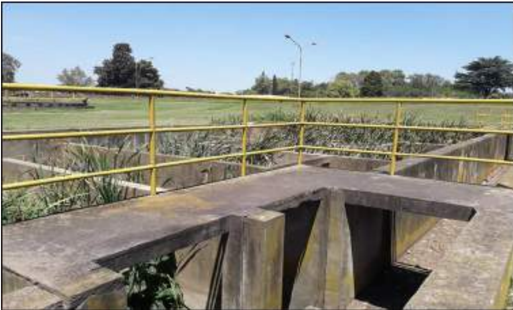
Cámara de Contacto y Sala de Cloración. Fuente: Fotografía Propia
