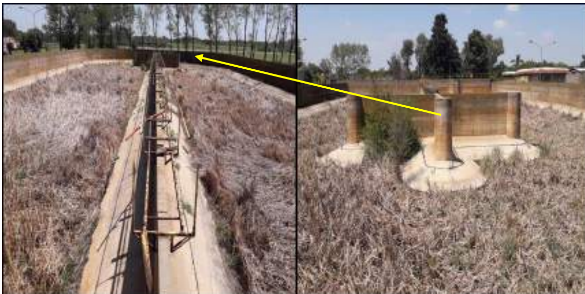
Piletas de Aireación. Fuente: Fotografía Propia.
