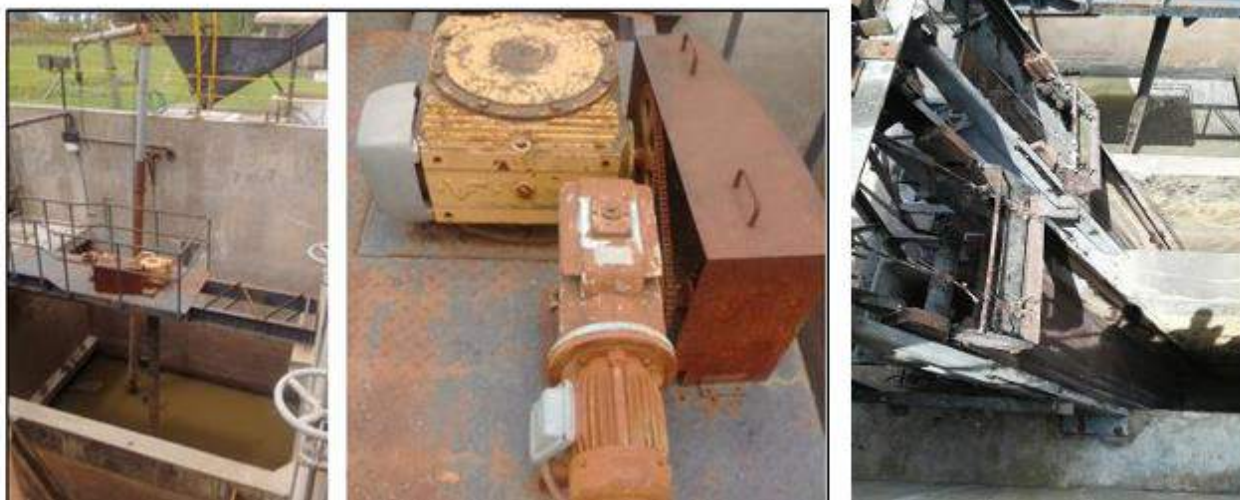
Sistema de Rejas Gruesas. 2017
