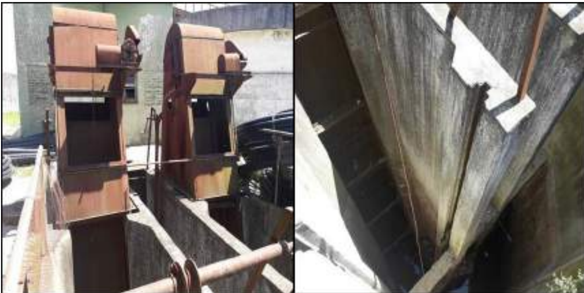
Sistema de Rejas. Fuente: Fotografía Propia
