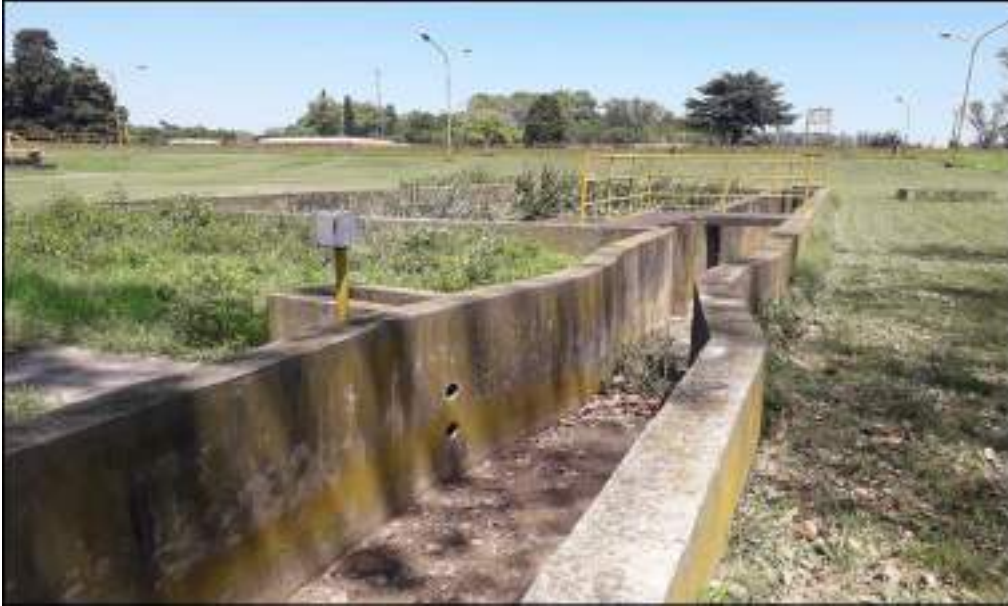
Canaleta Parshall. Fuente: Fotografía Propia
