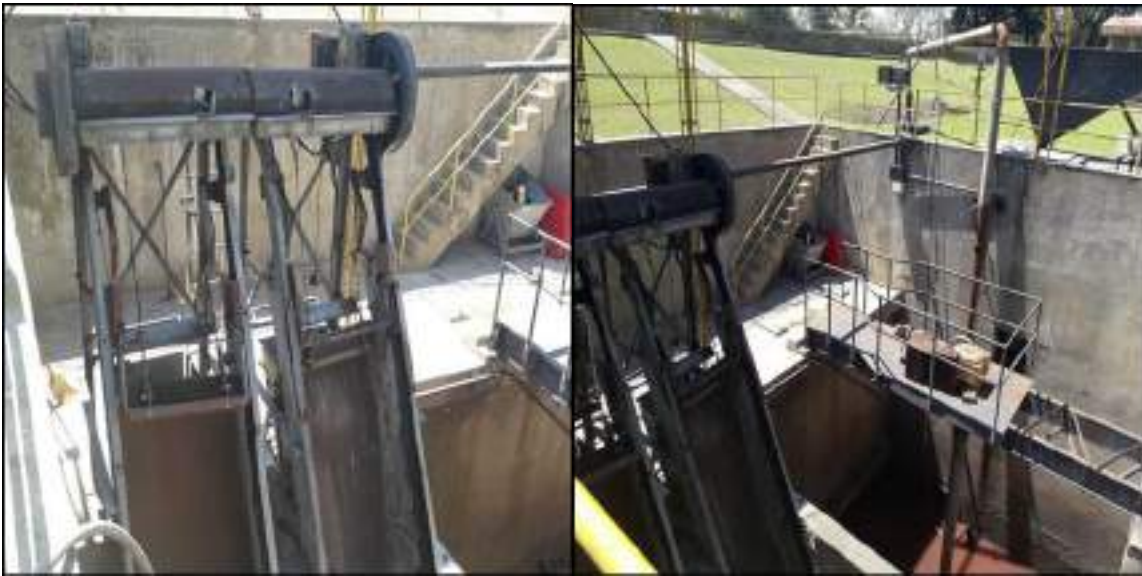
Sistema de Rejas Gruesas. Fuente: Fotografía Propia.
