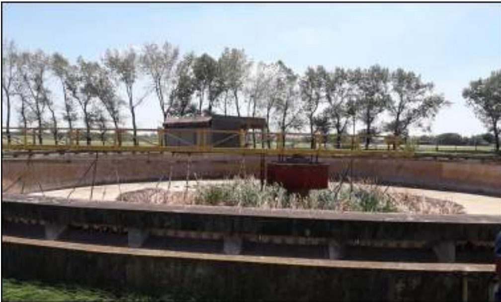
Sedimentador Secundario. Fuente: Fotografía Propia
