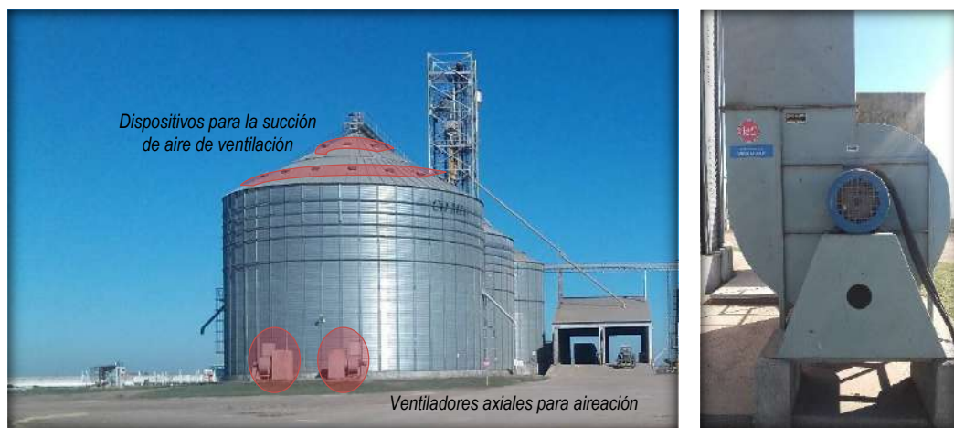
Silos con vista de ventiladores para aireación y dispositivos de succión de aire que poseen los mismos.
