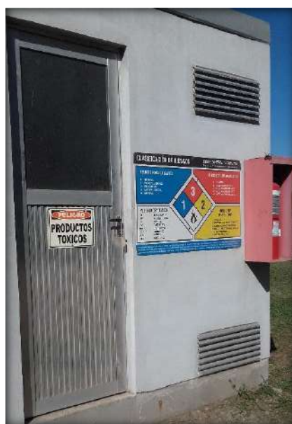
Sector de almacenamiento de fitosanitizantes.
