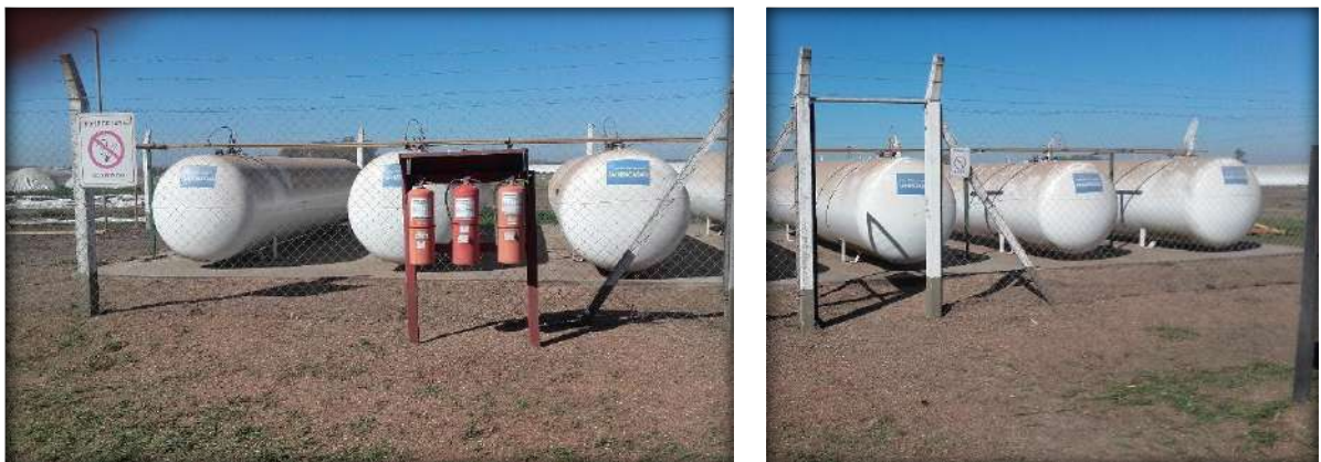
Vista de los zeppelines de GLP H-2026-13698205-GDEBA-DGAMAMGP
