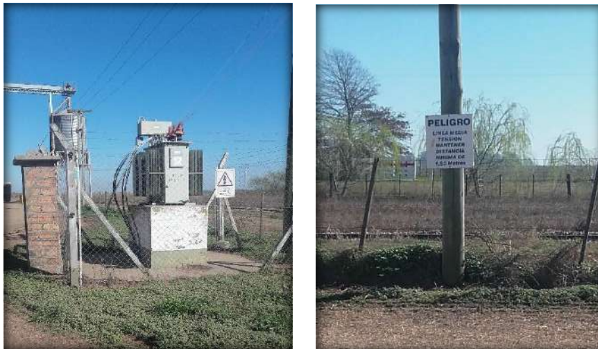
Vista de transformador instalado en el predio y señalización correspondiente.
