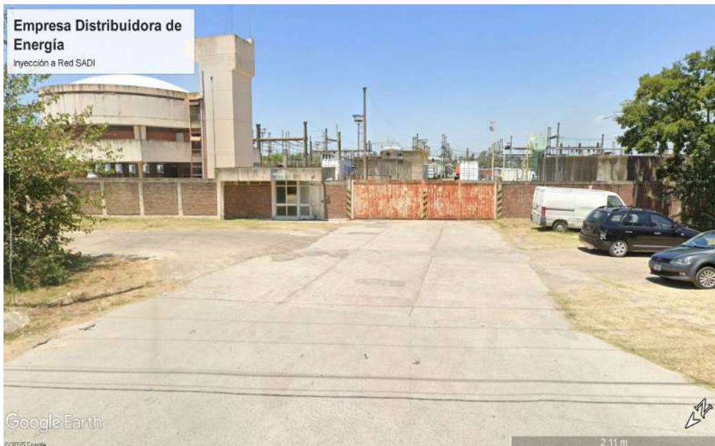
Imagen. Empresa Distribuidora de Energía Eléctrica desde RP N° 25. Fuente: Google Earth Pro.
