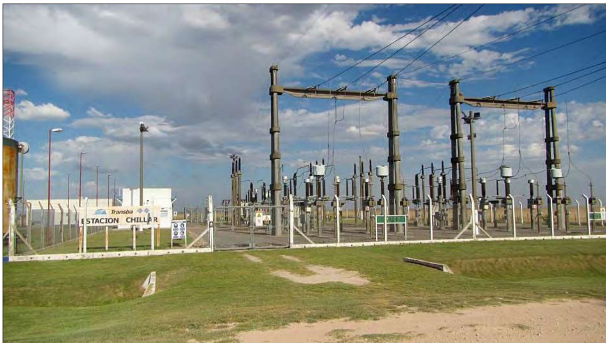
41 - P15. (37.300525° S / 60.117792° O). ET Chillar (TRANSBA SA).
