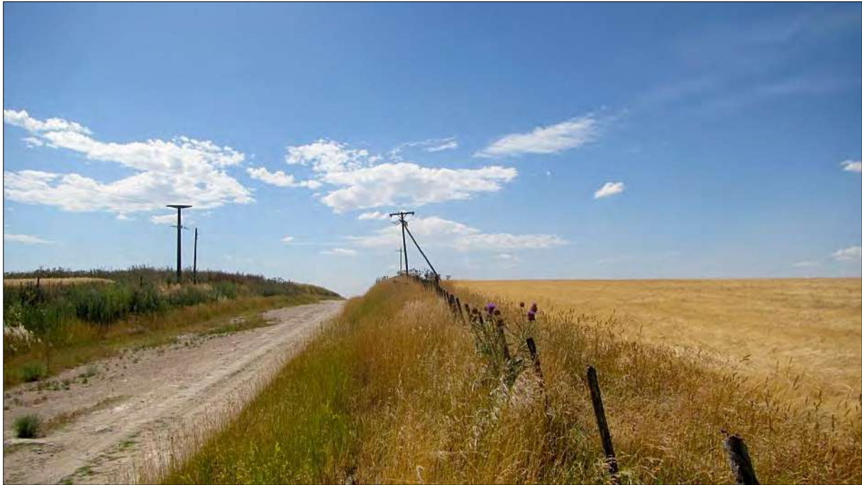
26 - P10a. (37.337195° S / 59.990956° O). La Alternativa Centro (verde) transcurre, hacia la ET Chillar por dentro del campo, paralela al alambrado y al camino rural.
