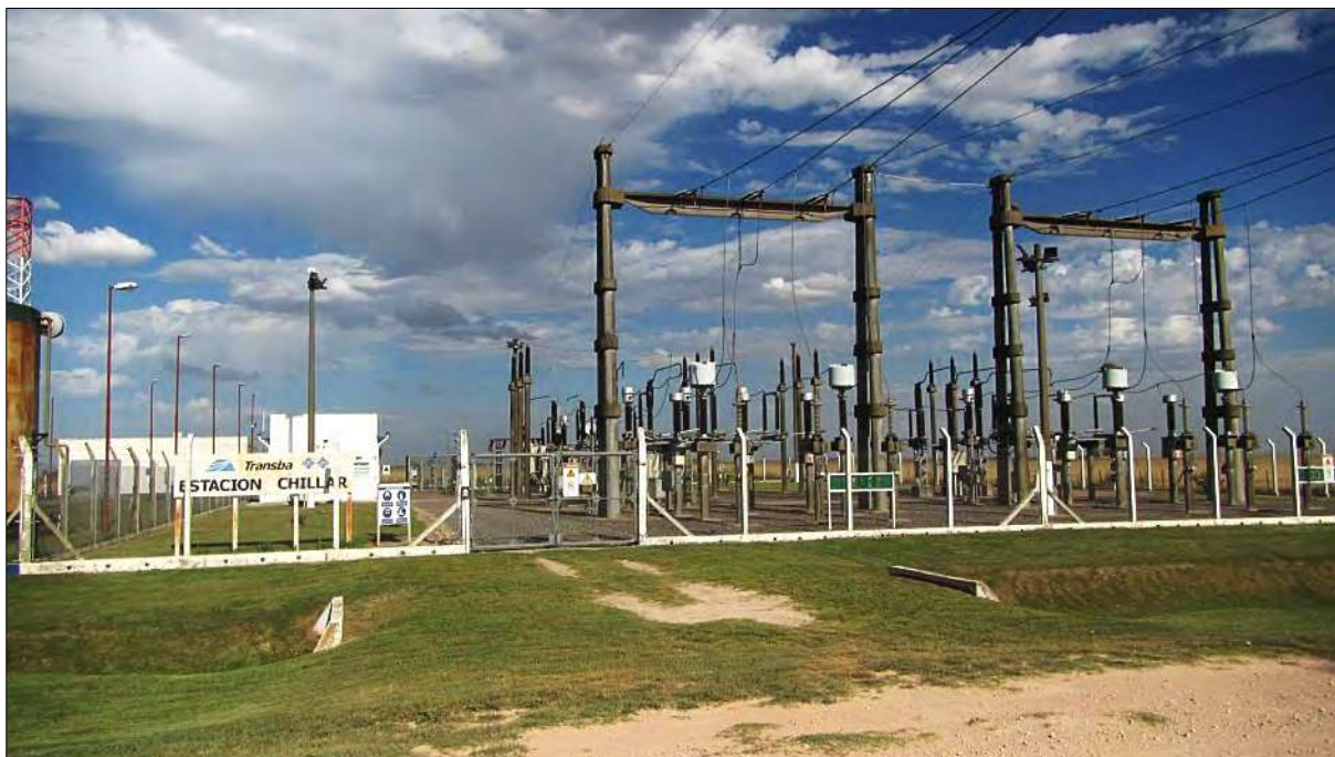
40 - P15. (37.300525° S / 60.117792° O). ET Chillar (TRANSBA SA).
