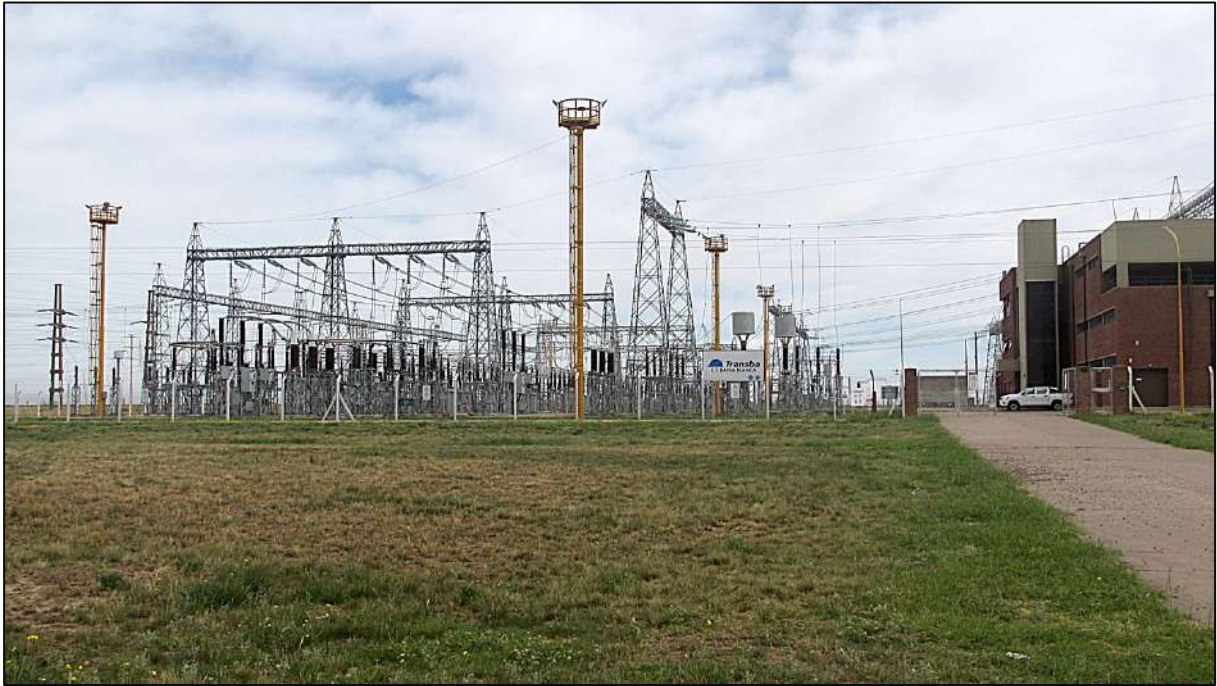
Sitio 14 (38,66010°S 62,05352°O). Estación Transformadora Bahía Blanca, sector TRANSBA.
