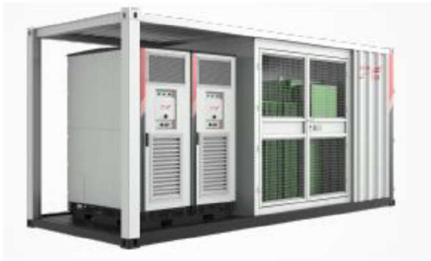
Figura 7. Contenedor PCS-transformador. Fuente. GENNEIA S.A.
