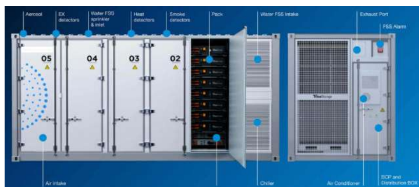
Imagen 6. Sistema de gestión (BMS). Fuente. GENNEIA S.A.
