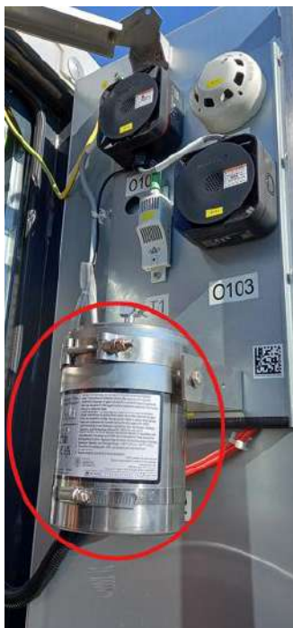
Imagen 5. Sistema contra incendios.
