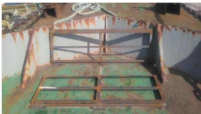
Estructuras metálicas para sujetar las placas
