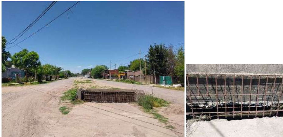
Foto 17: en detalle sobre 9 de Julio, arroyo Tajamar que se encuentra entubado, que cruza por el predio de la Planta, sigue en calle diagonal entubado y en la calle José Hernández comienza a circular canalizado a cielo abierto.
